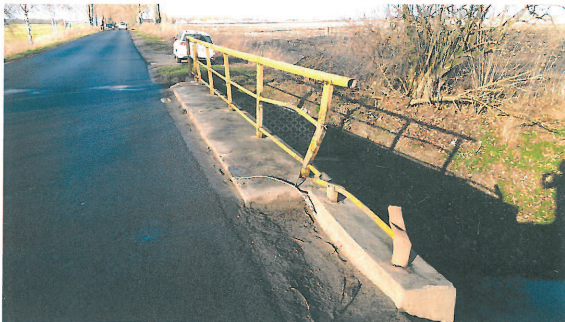
Fot. 1. Zniszczona, skorodowana i niepełna stalowa balustrada.
