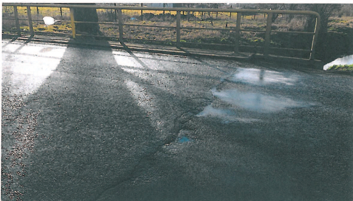
Fot. 2. Spękania nawierzchni, oraz jej zaniżenie.
