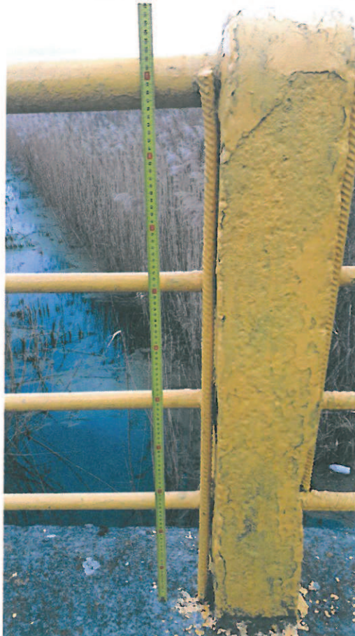
Fot. 9. Wysokość balustrady niezgodna z Dz.U. 2000 nr 63 poz.735 rozdział 9 §252 p.1.
