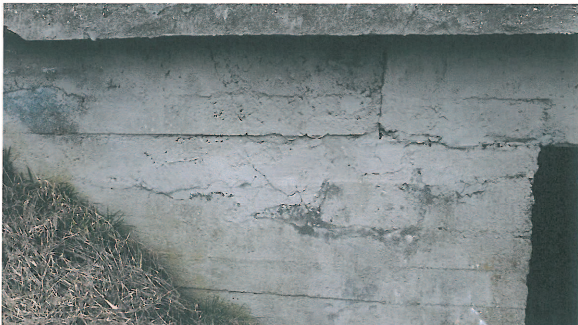
Fot. 10. Spękania, wykwity, zanieczyszczenia i korozja betonu skrzydła przyczołka.
