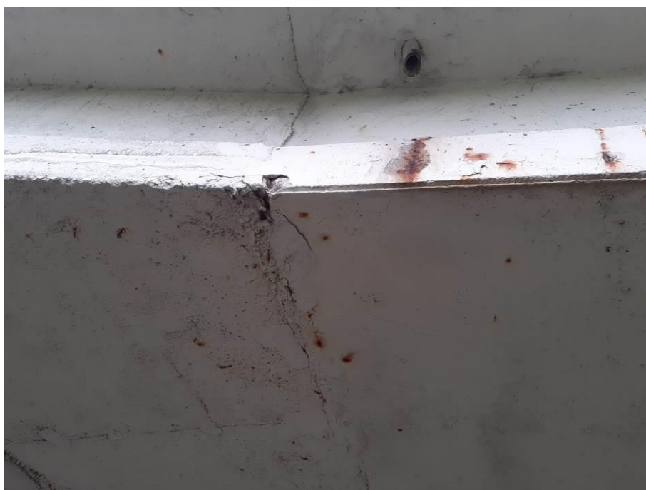
Fot. 6. Zarysowania w miejscach zespolenia dźwigarów z poprzecznicą podporową, korozja zbrojenia – powszechnie występujące uszkodzenie
