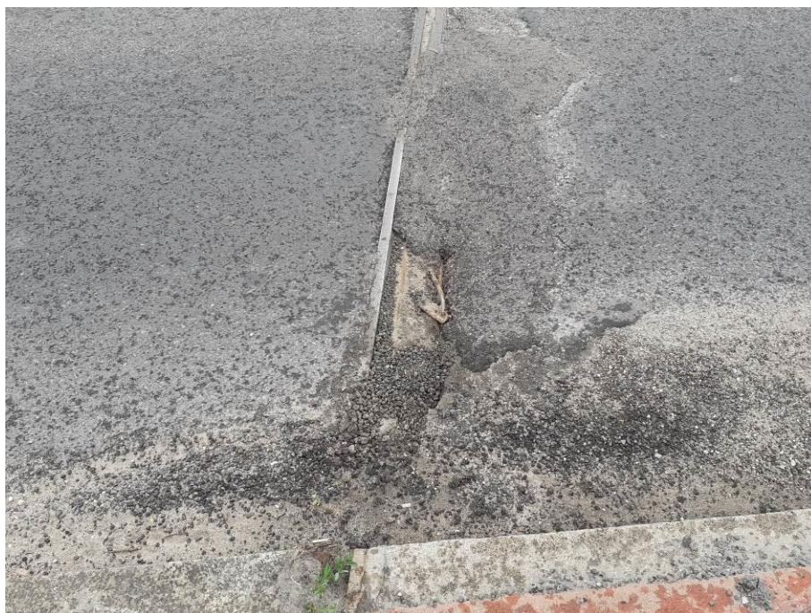
Fot. 3. Ubytki asfaltu, zdeformowane profile urządzenia dylatacyjnego
