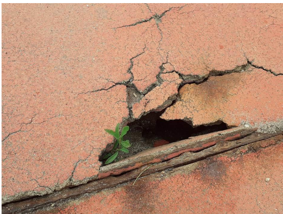
Fot. 2. Zniszczone przykrycie otworu technicznego na chodniku
