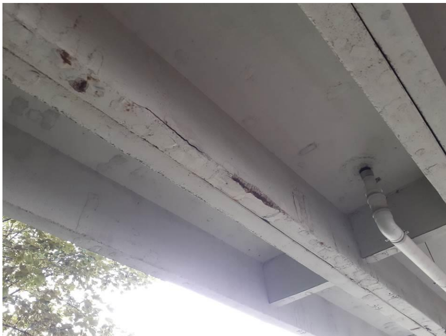
Fot. 5. Zarysowania i ubytki otuliny zbrojenia z rdzawym nalotem świadczącym o postępującej korozji – powszechnie występujące uszkodzenie
