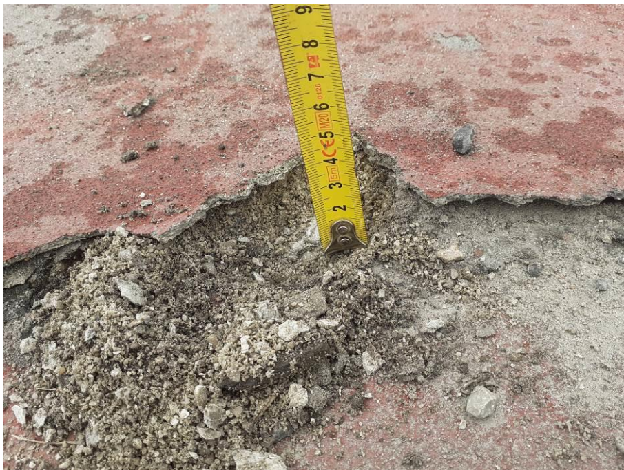
Fot. 1. Zniszczenie struktury betonu na chodnikach
