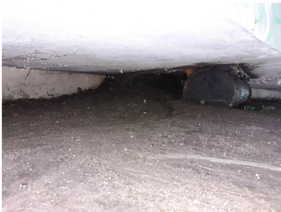
Fot. 4. Zanieczyszczenia i zalanie ławy podłożyskowej w wyniku nieszczelności dylatacji
