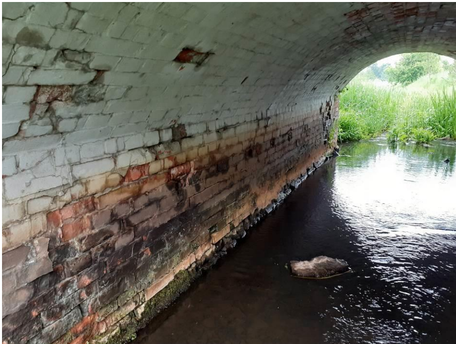
Fot. 2. Ubytki cegieł i spoin, zarysowania i wegetacja glonów i mchów na ścianach przepustu
