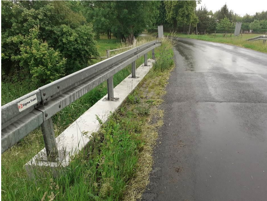
Fot. 1. Wegetacja roślin na poboczu utwardzonym, prowadnice balustrady na wysokości 0,93 m od jezdni
