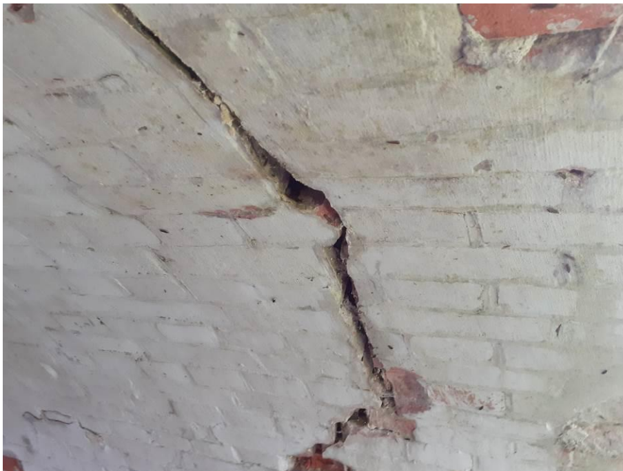
Fot. 3. Pęknięcie na połączeniu konstrukcji przepustu z głowicą wylotową
