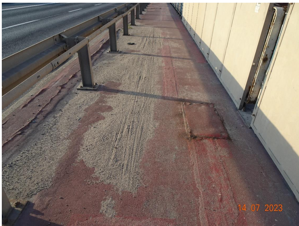
Fot. 53. Chodnik po stronie wschodniej. Akumulacja zanieczyszczeń. Korozja pokrywy studzienki
