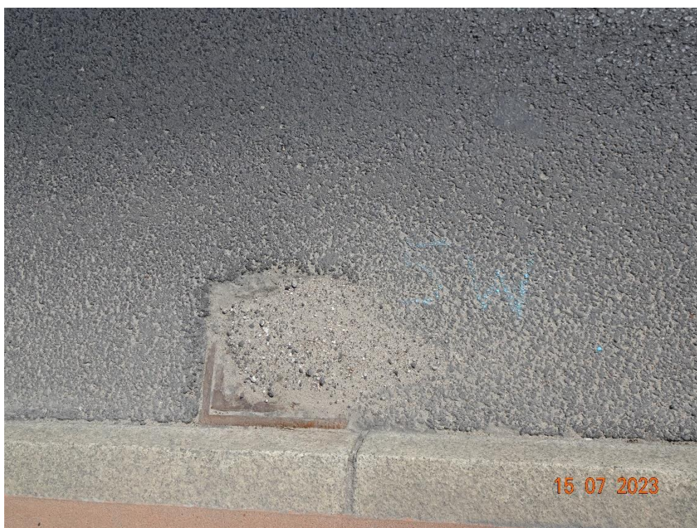
Fot. 82. Przykładowy widok wpustu na jezdni. Zanieczyszczenie materiałem ziemnym. Podobne uszkodzenie dotyczy większości wpustów po stronie zachodniej.
