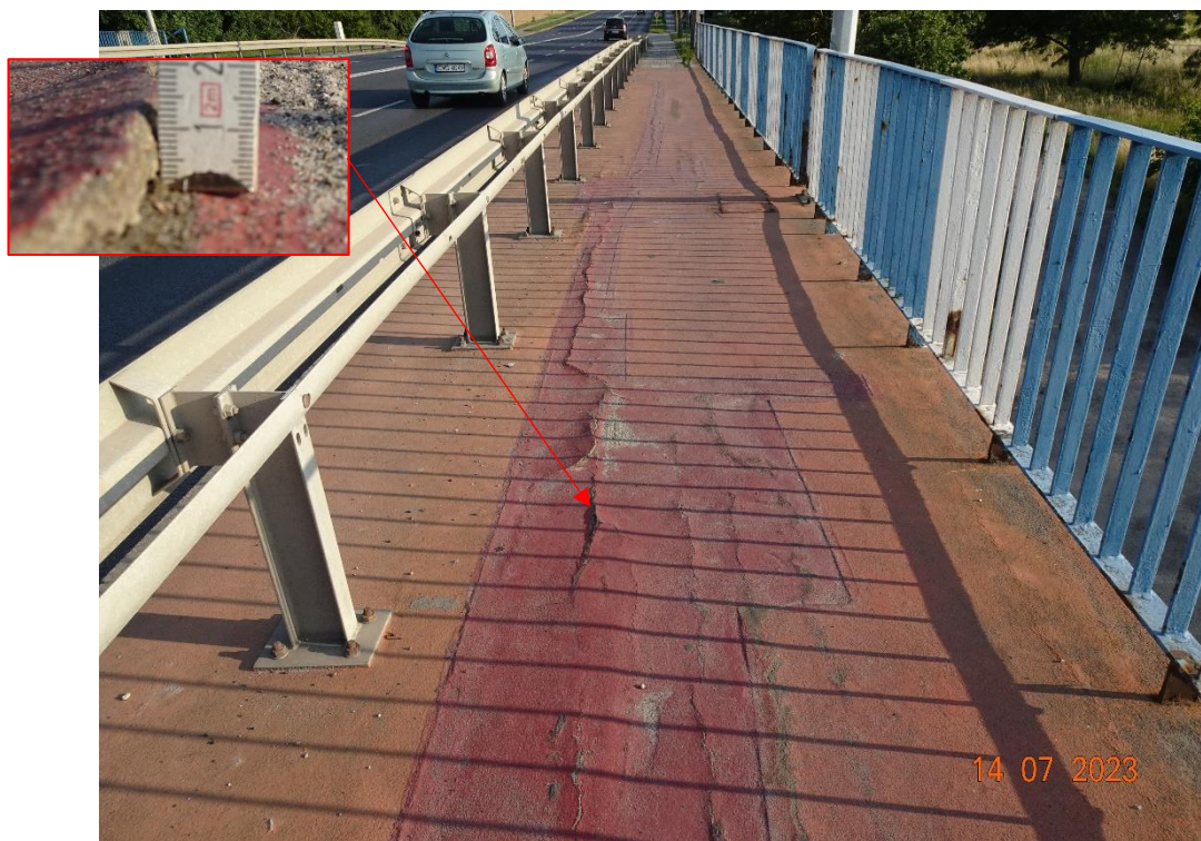
Fot. 48. Chodnik po stronie zachodniej. Widoczne ślady napraw zarysowań oraz odnowione pęknięcia nawierzchni. Przyczyną jest błędne rozwiązanie połączenia elementów betonowych pod nawierzchnią. Uszkodzenie występuje na obu chodnikach, na całej długości obiektu. Pęknięcia pozwalają na swobodną penetrację wody oraz sprzyjają akumulacji zanieczyszczeń.
