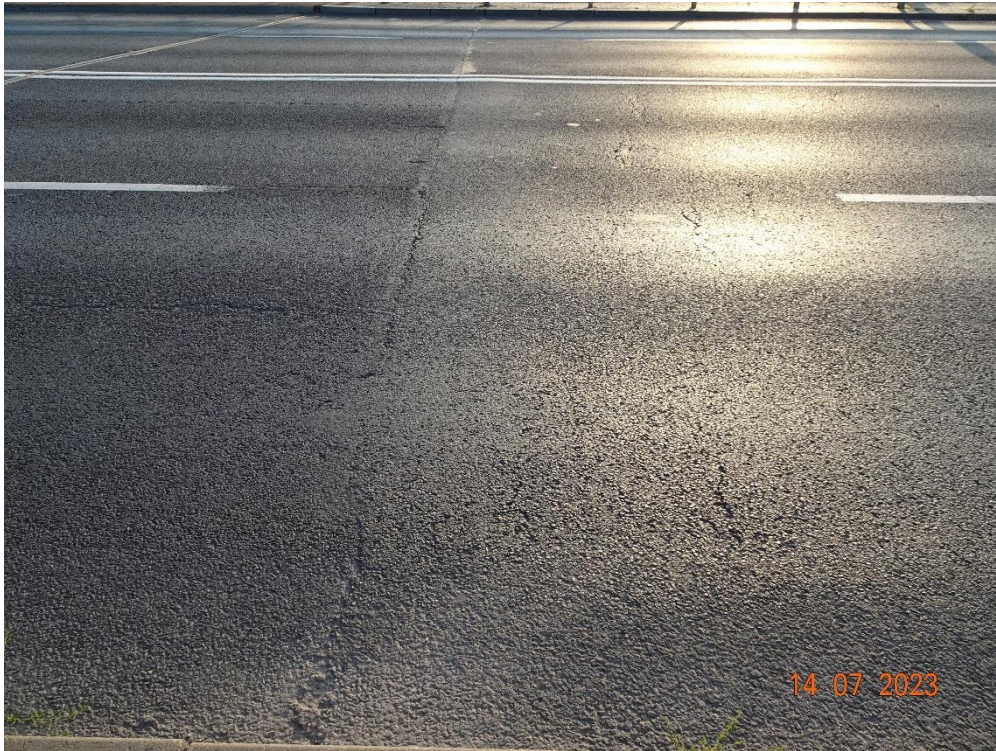
Fot. 35. Widok nawierzchni w obrębie dojazdu od centrum miasta. Poprzeczna rysa technologiczna oraz liczne poprzeczne zarysowania świadczące o utracie nośności warstw nawierzchni.
