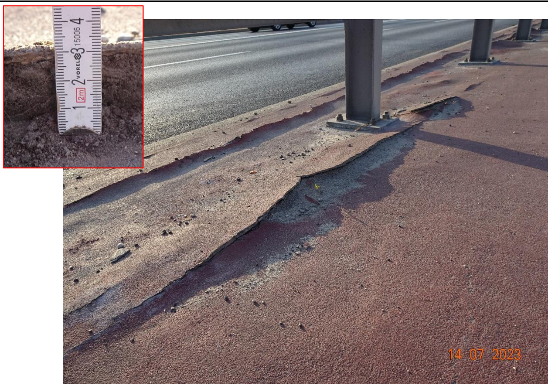
Fot. 52. Chodnik po stronie wschodniej. Akumulacja zanieczyszczeń na chodniku oraz na jezdni. Pęknięcia nawierzchni chodnika. Pęknięcie sprzyja zatrzymywaniu zanieczyszczeń na chodniku, oraz utrudnia odprowadzanie wody w kierunku jezdni.
