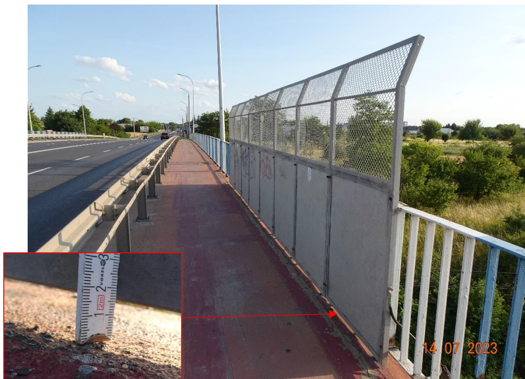
Fot. 60. Osłona przeciwporażeń nie przylega szczelnie do nawierzchni chodnika (widok po stronie zachodniej); graffiti na osłonie.
