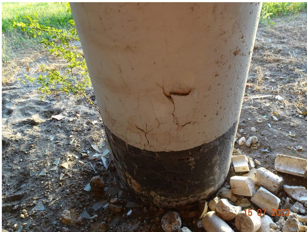
Fot. 123. Podpora nr 2. Zarysowanie i odspojenie betonu wyprawy na słupie.
