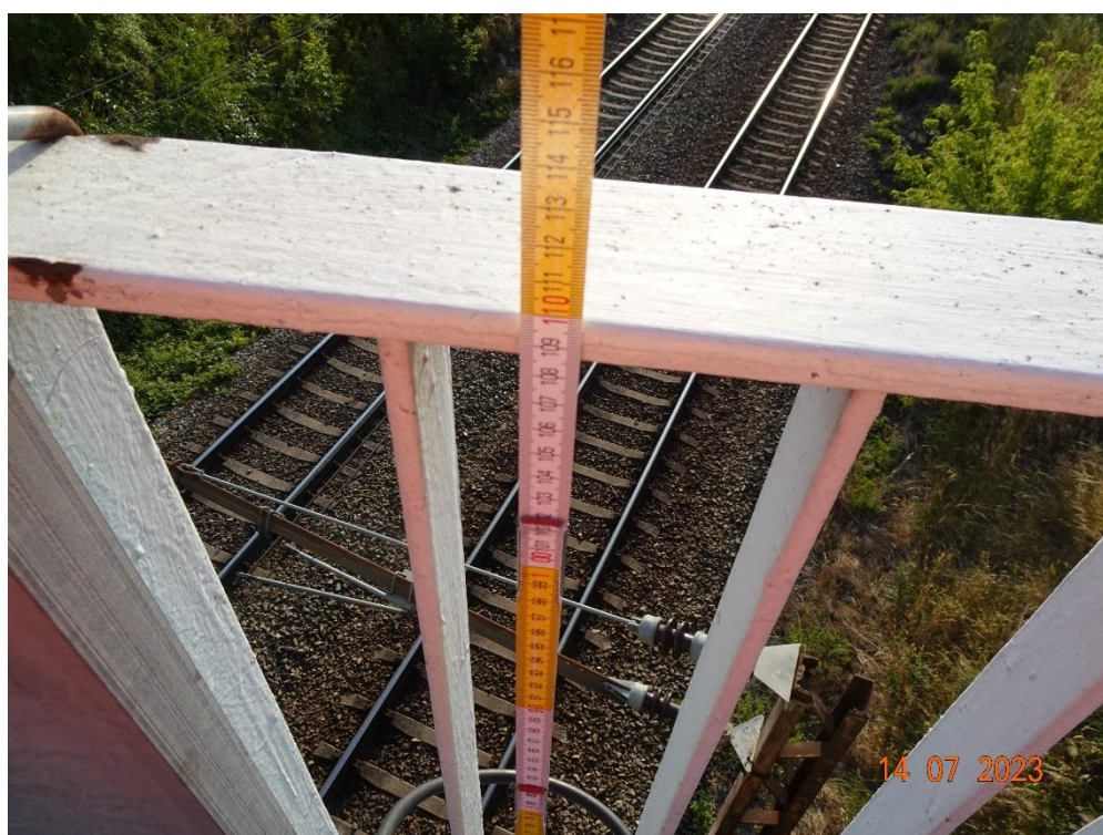
Fot. 56. Wysokość balustrady na obiekcie nieodpowiednia dla obiektu usytuowanego nad linią kolejową (wymagane 130 cm).
