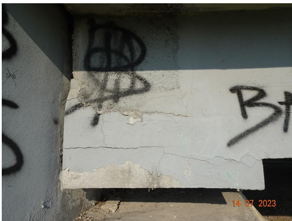
Fot. 86. Poprzecznicą podporowa nad podporą nr 1. Zarysowania.
