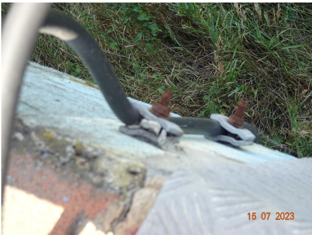
Fot. 140. Zaawansowana korozja mocowania kabla (widok przy podporze nr 5).
