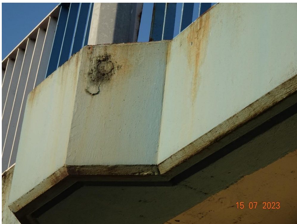
Fot. 73. Gzyms po stronie zachodniej. Korozja zbrojenia.
