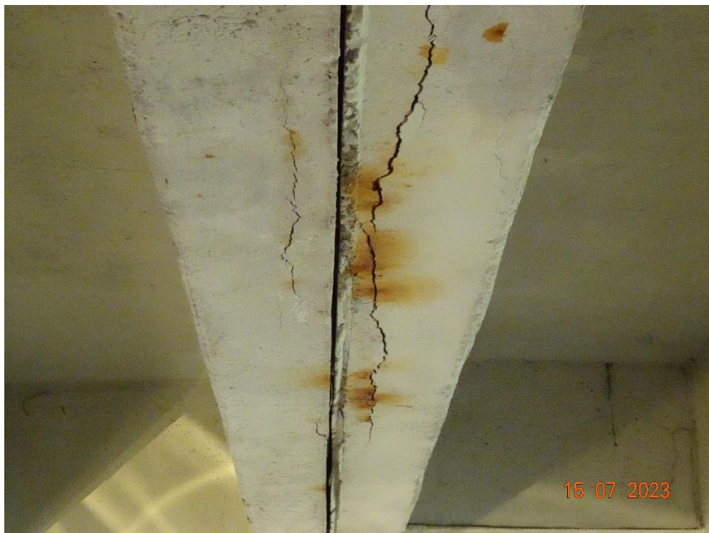
Fot. 85. Przesło 1-2. Korozja zbrojenia belek (zbrojenie sprężające). Liczne i rozległe zarysowania wzdłuż korodującego zbrojenia.
