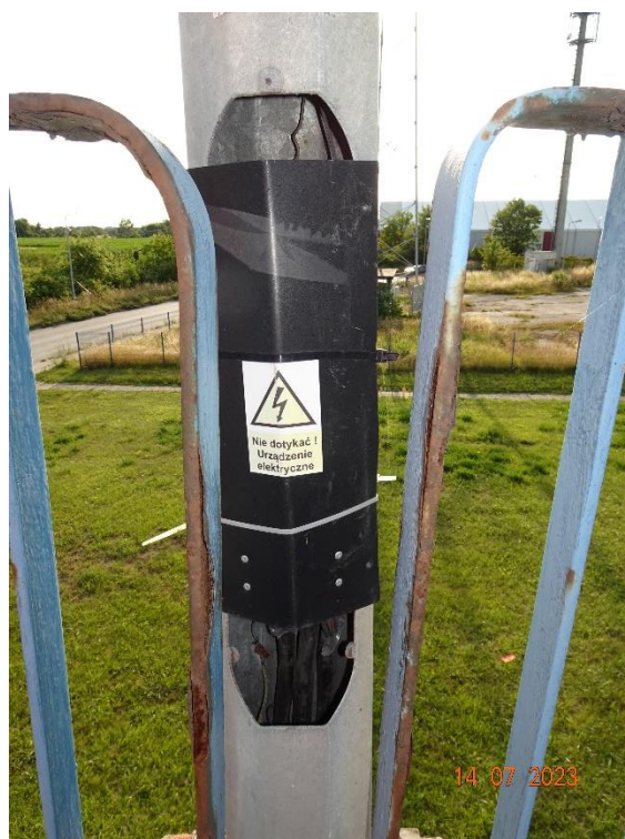
Fot. 138. Słupy oświetleniowy po stronie zachodniej (w pobliżu podpory nr 1). Brak właściwego zabezpieczenia pokrywą rewizyjną stwarzający zagrożenie dla użytkowników.
