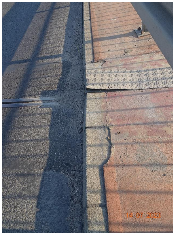
Fot. 113. Deformacja blachy osłonowej spowodowana prawdopodobnie uderzeniem pojazdu (np. pługu); akumulacja zanieczyszczeń; ubytek nawierzchni chodnika. Widok nad podporą nr 1.
