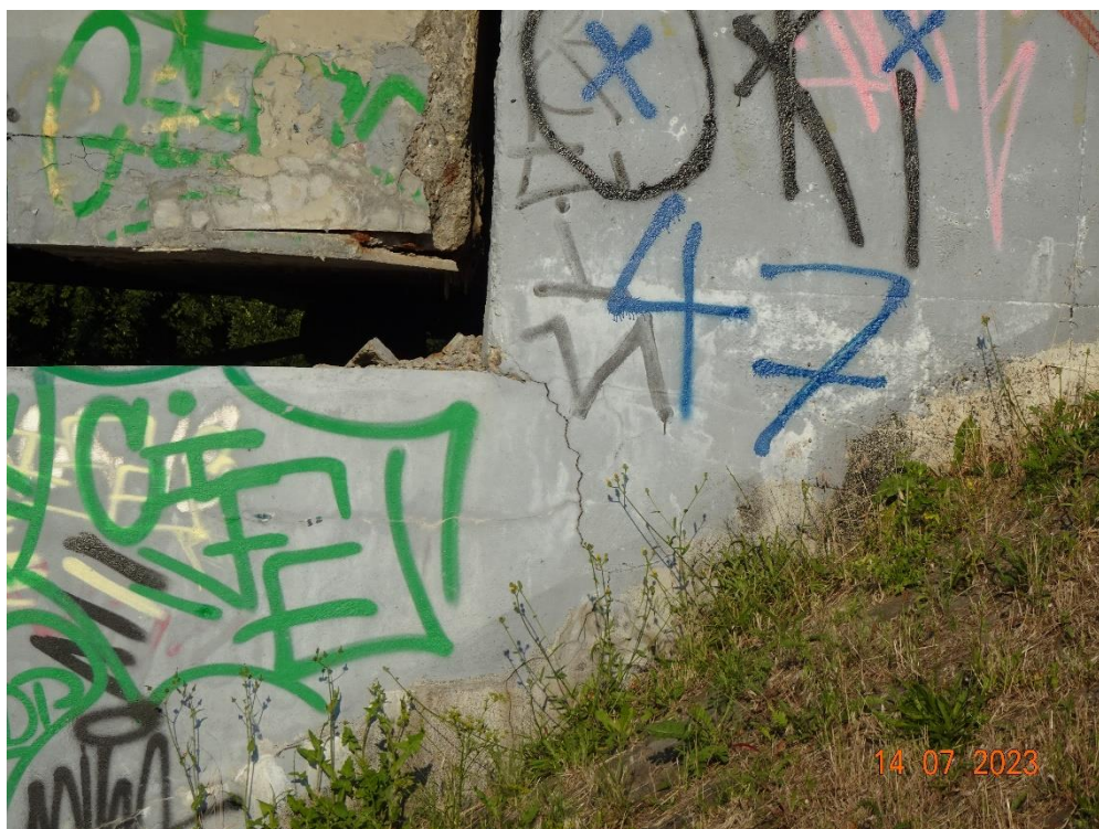
Fot. 121. Zarysowanie na przyczółku nr 9. Widok od strony zachodniej. Charakter rysy wskazuje na blokadę swobody przesuwu (brak możliwości jednoznacznego ustalenia czy blokada występuje ze względu na trudny dostęp do szczeliny dylatacyjnej). Ubytek betonu przesła.
