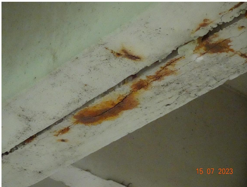
Fot. 99. Zarysowanie belek oraz oznaki korozji zbrojenia sprężającego. Przęsło 6-7.
