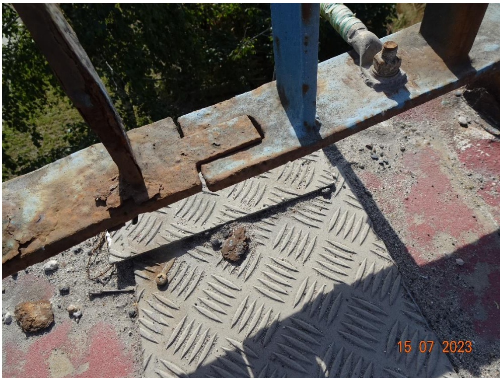
Fot. 67. Korozja balustrady; brak swobody przesuwu elementów balustrady spowodowany niewłaściwym rozwiązaniem geometrycznym połączenia.
