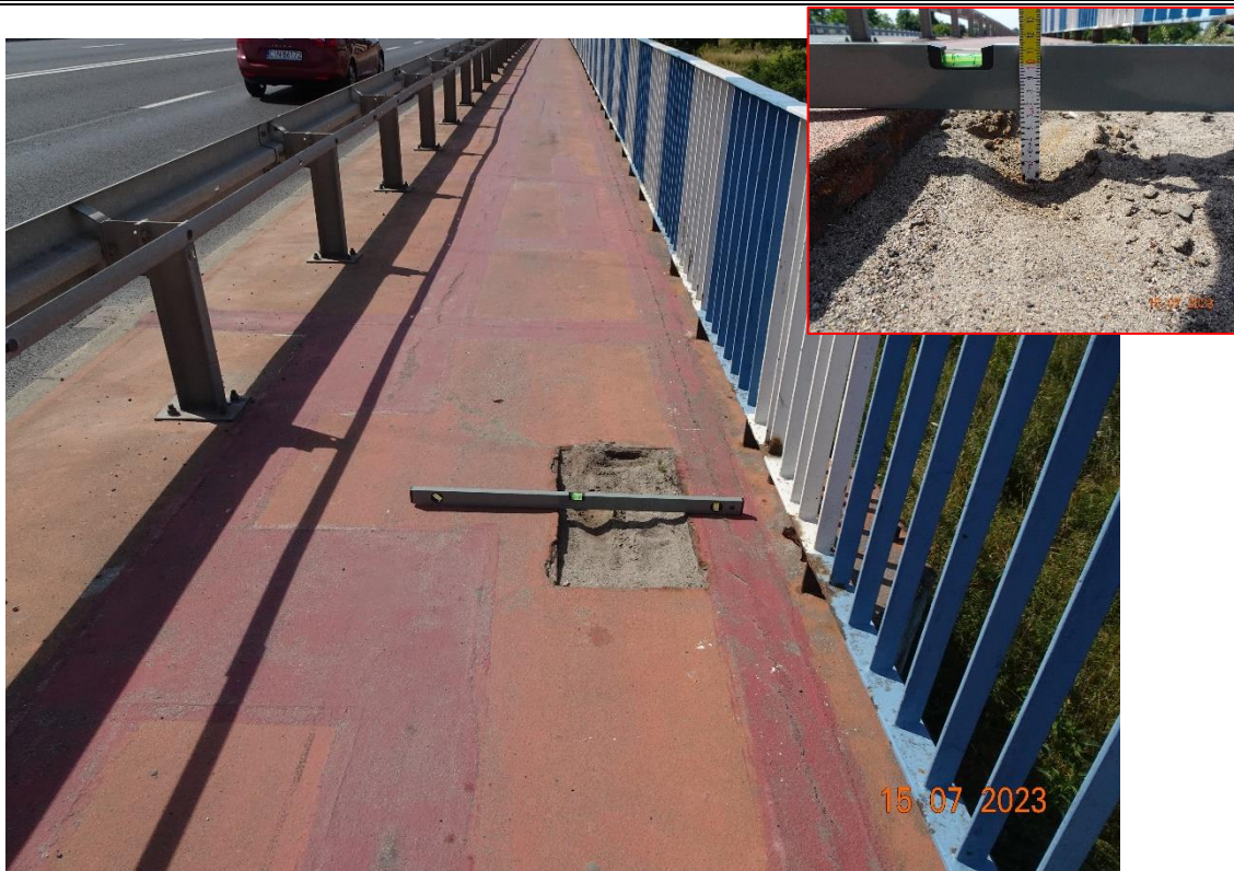
Fot. 47. Obniżenie pokrywy studzienki kablowej o około 6 cm stwarzające ryzyko potknięcia. Zanieczyszczenie materiałem ziemnym.
