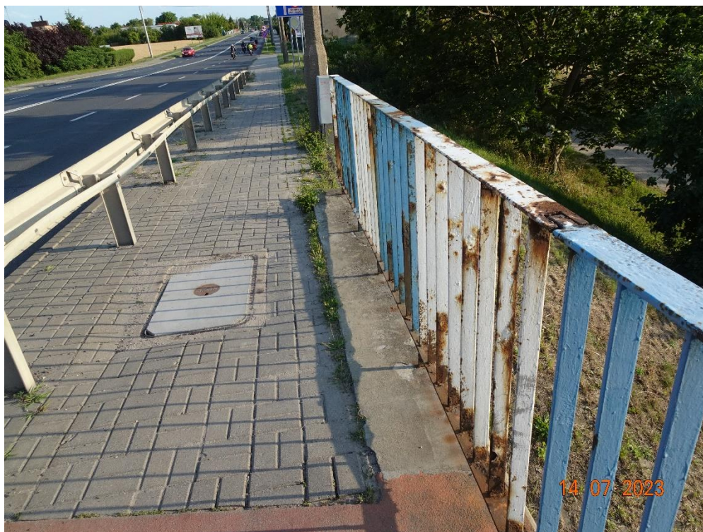
Fot. 57. Zaawansowana korozja balustrad. Przyczyną jest starzenie powłok antykorozyjnych. Uszkodzenie występuje w różnym stopniu na całym obiekcie.
