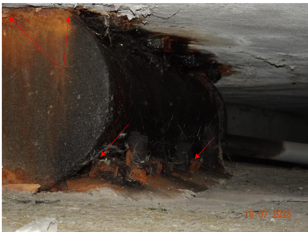
Fot. 102. Widok łożyska na podporze 1. Korozja stalowych części (korozja szczelinowa wynikająca z braku możliwości skutecznego zabezpieczenia styku ruchomego wałka z płytami dolną i górną) napędzana przez przecieki wody z rejonu dylatacji oraz brak powłok antykorozyjnych i brak konserwacji smarem. Ponadto przypuszczalnie łożysko jest w skrajnym położeniu – dolne blokady przesuwu dotykają wałka.
