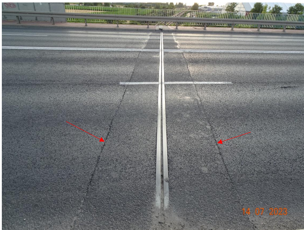
Fot. 114. Urządzenie dylatacyjne nad podporą nr 5. Pomierzono rozstaw 30 mm (adekwatny do temperatury konstrukcji). Widoczne rozszczelnienie styku nawierzchni jezdni z asfaltem przy dylatacji – przyczyną jest brak zastosowania uszczelnienia bitumicznego, np. zalewki.
