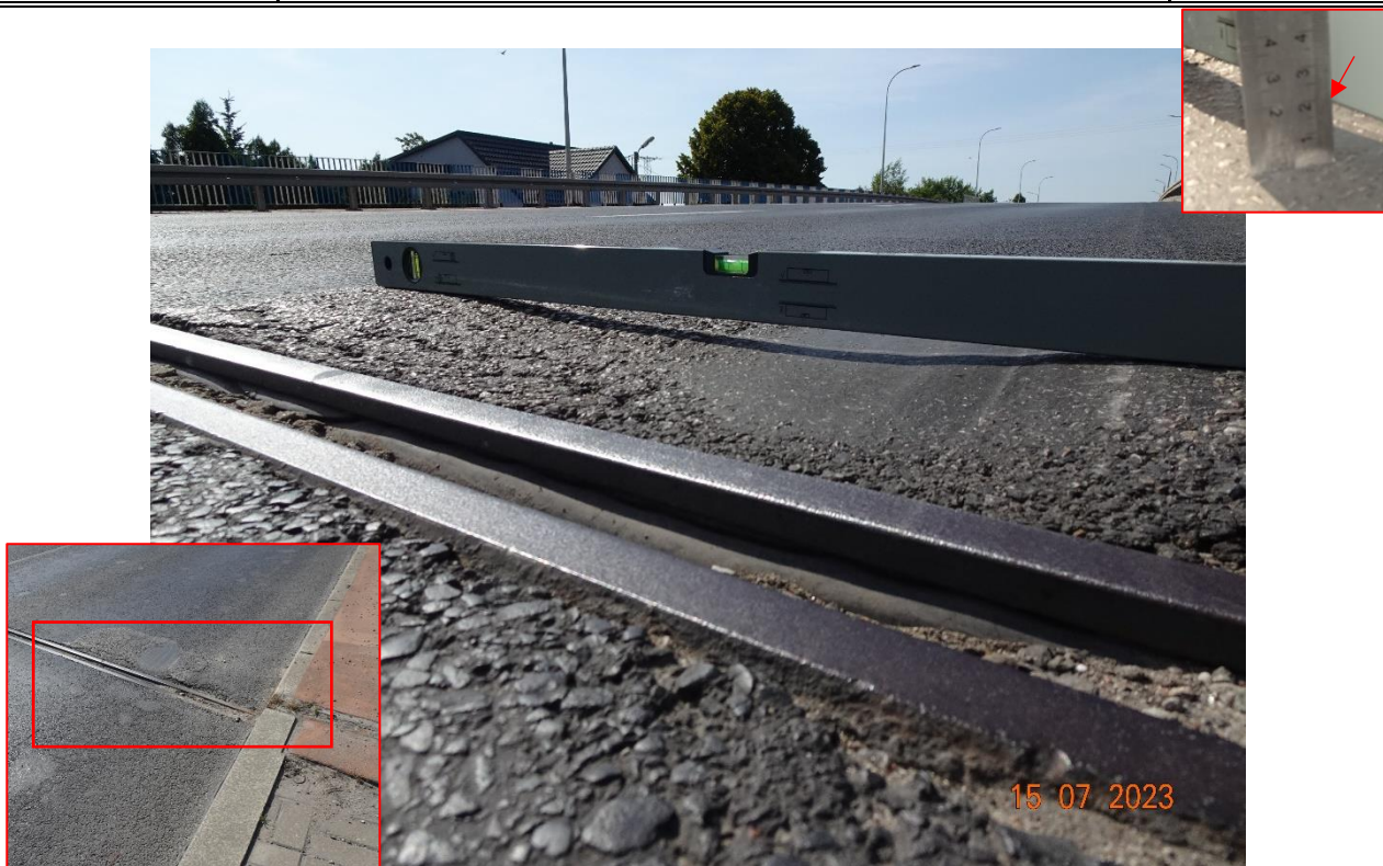
Fot. 39. Skoleinowanie nawierzchni na obiekcie na poziomie 2 cm – przyczyną jest utrata nośności oraz ruch ciężkich pojazdów.
