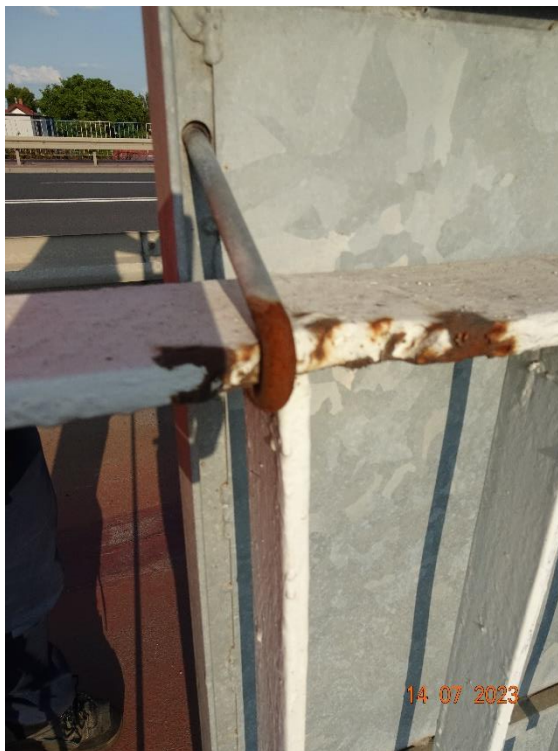
Fot. 61. Korozja łączników mocujących osłony do balustrad; korozja balustrad. Widok po stronie chodnika zachodniego.
