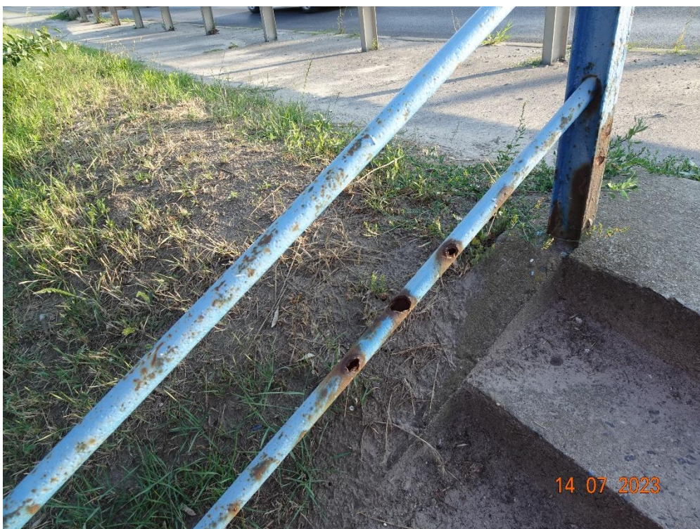
Fot. 32. Uszkodzenie powłok antykorozyjnych oraz zaawansowana korozja elementów balustrady na schodach (perforacje). Przyczyną jest brak właściwego zabezpieczenia antykorozyjnego.
