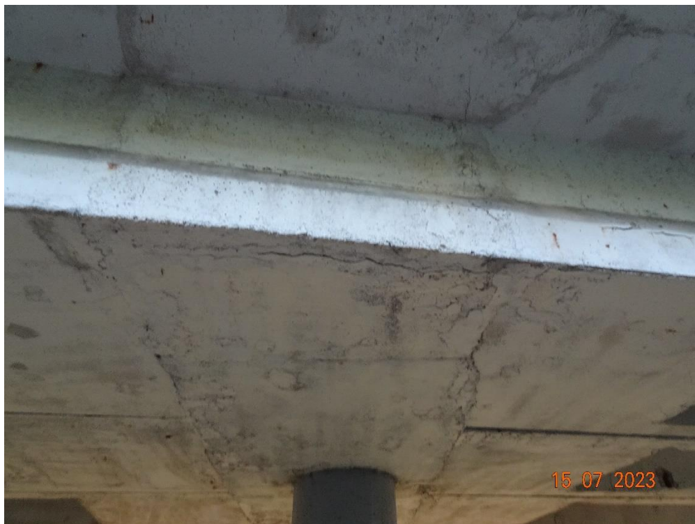
Fot. 137. Podpora nr 8. Zarysowanie oczeputu w kierunku podłużnym. Przyczyną może być korozja zbrojenia.
