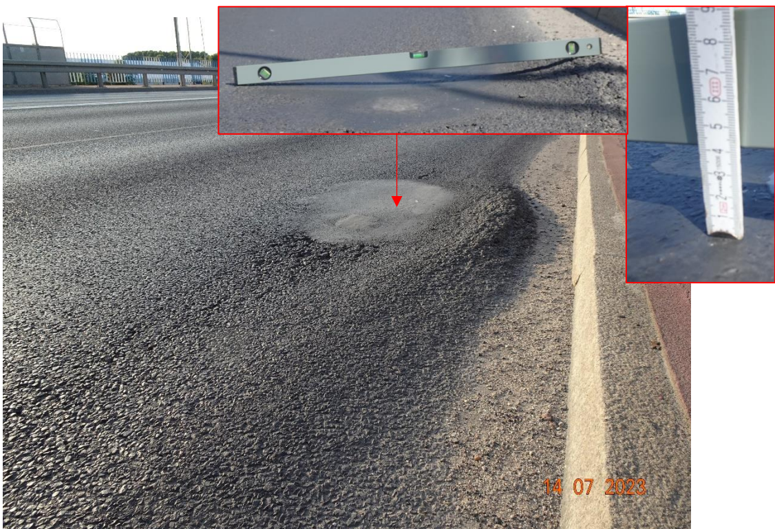
Fot. 38. Skoleinowanie nawierzchni na obiekcie – przyczyną jest utrata nośności oraz ruch ciężkich pojazdów.
