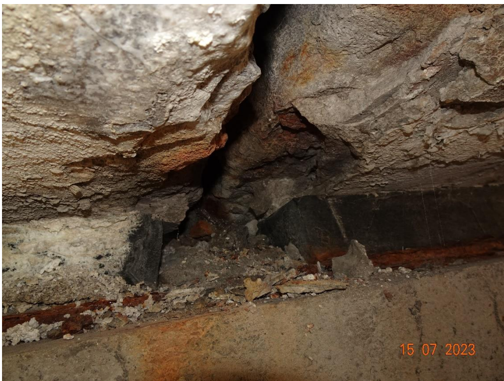
Fot. 106. Łożyska elastomerowe na podporze nr 5. Zaawansowana korozja blach dolnych (spowodowana przez brak zabezpieczenia antykorozyjnego), ubytki betonu nad łożyskiem, osady na łożysku po stronie przęsła 5-6, akumulacja zanieczyszczeń. Przyczyną obserwowanego stanu mogą być niedoskonałości wykonawcze oraz brak szczelności urządzenia dylatacyjnego (na co wskazują osady i wykruszenia betonu).
