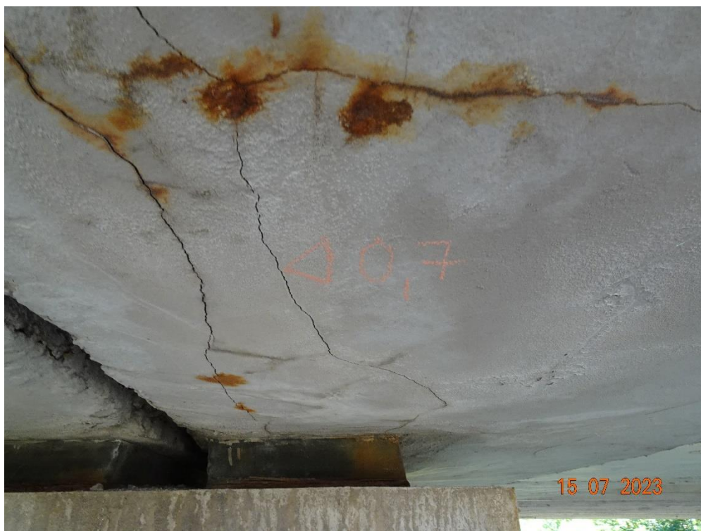
Fot. 95. Zarysowanie betonu wyprawy w rejonie podpory nr 5. Korozja zbrojenia. Potencjalną przyczyną korozji jest przeciekanie wody przez styk izolacji i profilu dylatacyjnego. Przęsło 4-5.
