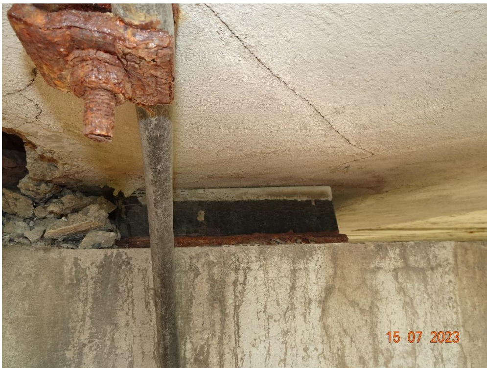
Fot. 139. Zaawansowana korozja mocowania kabla (widok przy podporze nr 5).
