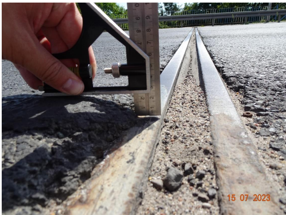
Fot. 115. Urządzenie dylatacyjne nad podporą nr 9. Profil dylatacyjny znajduje się około 2,5 cm poniżej poziomu asfaltu (z powodu skoleinowania) co przyczynia się do wzmagania efektów dynamicznych.
