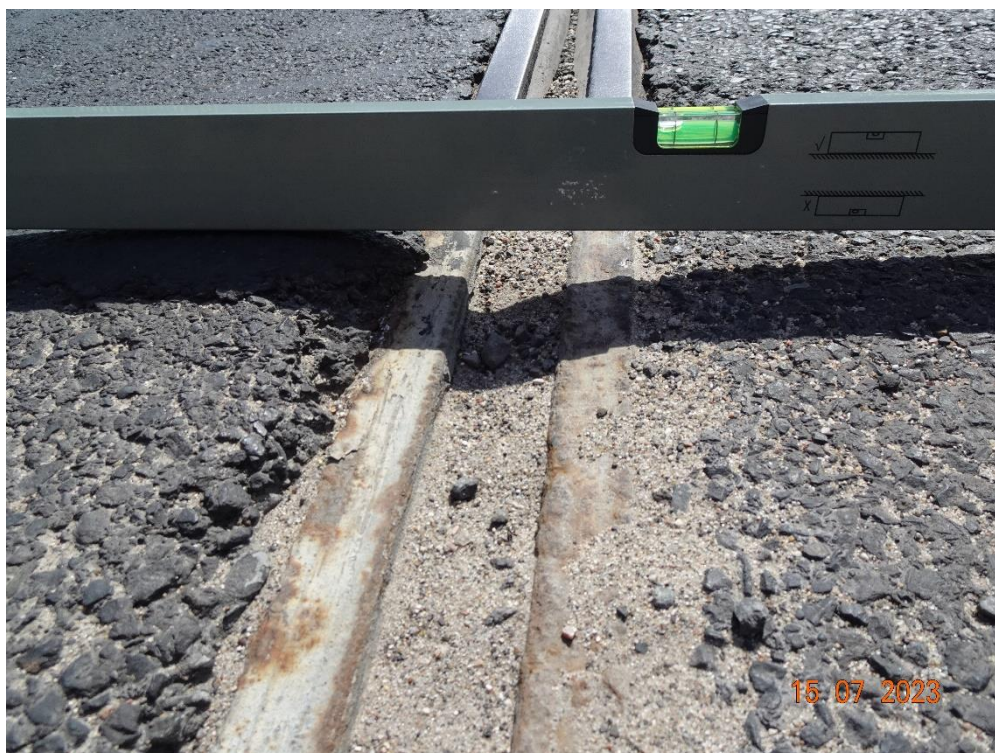
Fot. 116. Urządzenie dylatacyjne nad podporą nr 9. Nawierzchnia i urządzenie dylatacyjne nie zapewniają niezakłóconego przejazdu (różnica poziomów).
