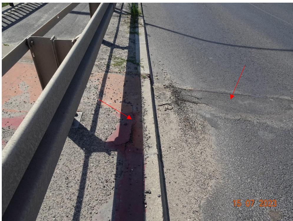
Fot. 41. Chodnik po stronie wschodniej przy podporze nr 9. Zarysowanie nawierzchni chodnika, zanieczyszczenie chodnika, zanieczyszczenie nawierzchni jezdni, uzupełnienie ubytku stalowego profilu dylatacyjnego masą asfaltową.
