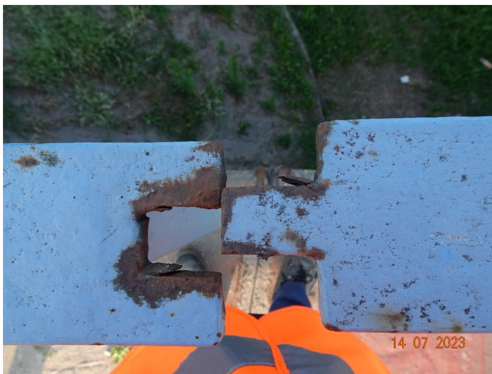
Fot. 66. Deformacja balustrady spowodowana niewłaściwym rozwiązaniem geometrycznym (kolizja). Widok nad podporą nr 5.
