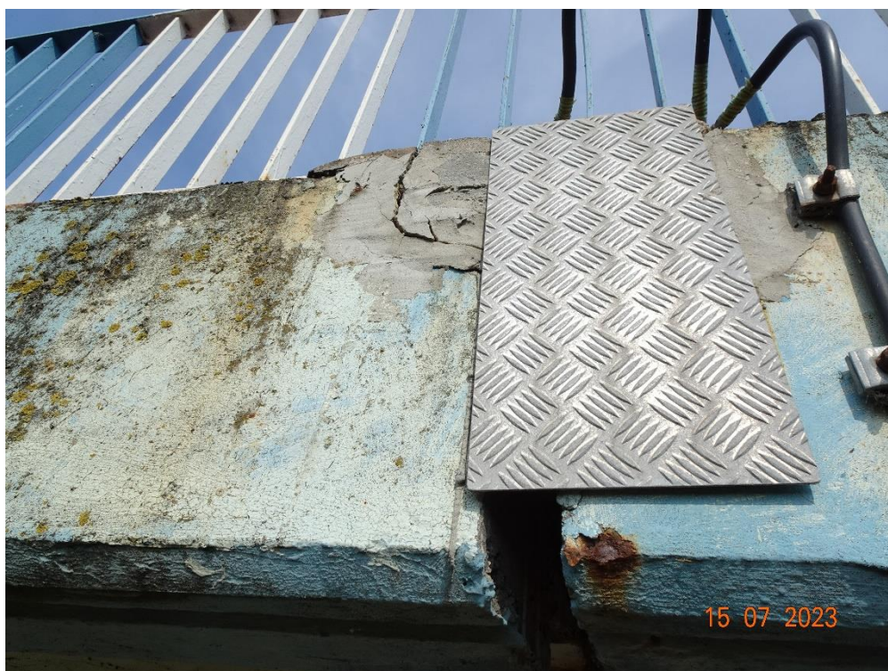
Fot. 74. Gzyms po stronie zachodniej. Pęknięcie warstwy naprawczej. Przypuszczalną przyczyną jest blokada swobody przesuwu przęsła.
