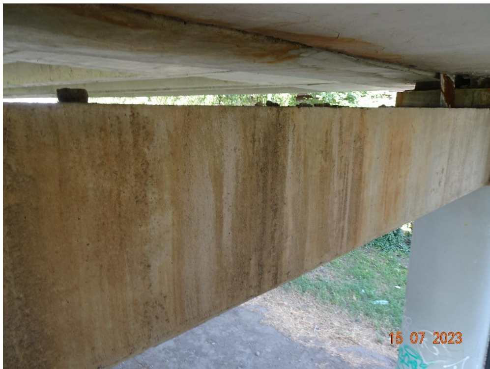
Fot. 129. Podpora nr 5. Zacieki na oczepie oraz rdzawe zacieki na spodzie poprzecznic. Ogólny charakter uszkodzeń wskazuje na przenikanie wody przez urządzenie dylatacyjne.
