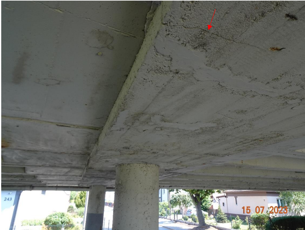
Fot. 125. Podpora nr 3. Zarysowanie oczepu podpierającego belki korytkowe. Uszkodzenie występuje analogicznie na wszystkich podporach. Przypuszczalną przyczyną może być przeciążenie lub ewentualnie korozja zbrojenia oczepu.
