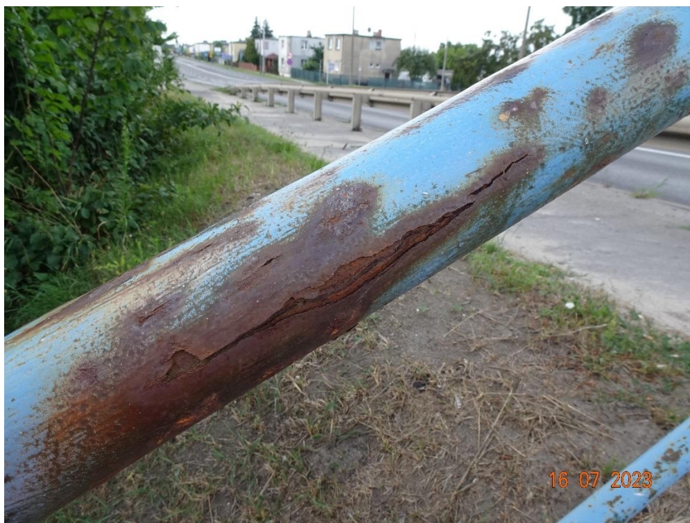
Fot. 34. Zaawansowana korozja elementów balustrady przy schodach. Przyczyną jest brak odpowiedniego zabezpieczenia antykorozyjnego.
