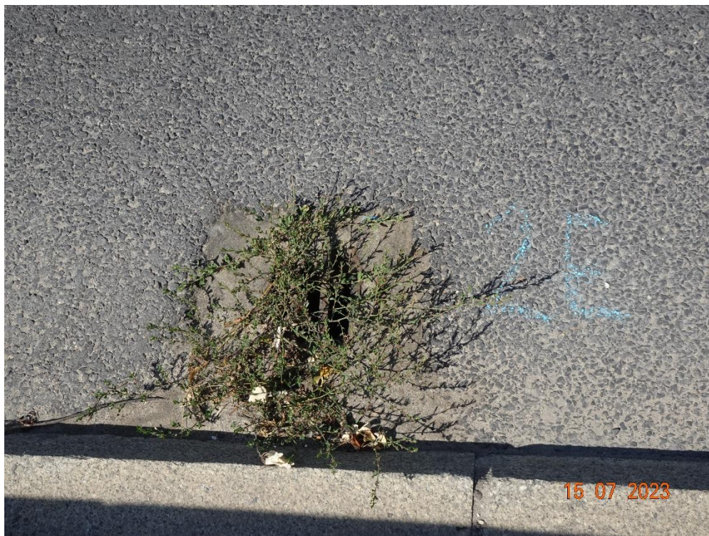
Fot. 81. Przykładowy widok wpustu na jezdni. Zanieczyszczenie materiałem ziemnym. Podobne uszkodzenie dotyczy większości wpustów po stronie wschodniej.
