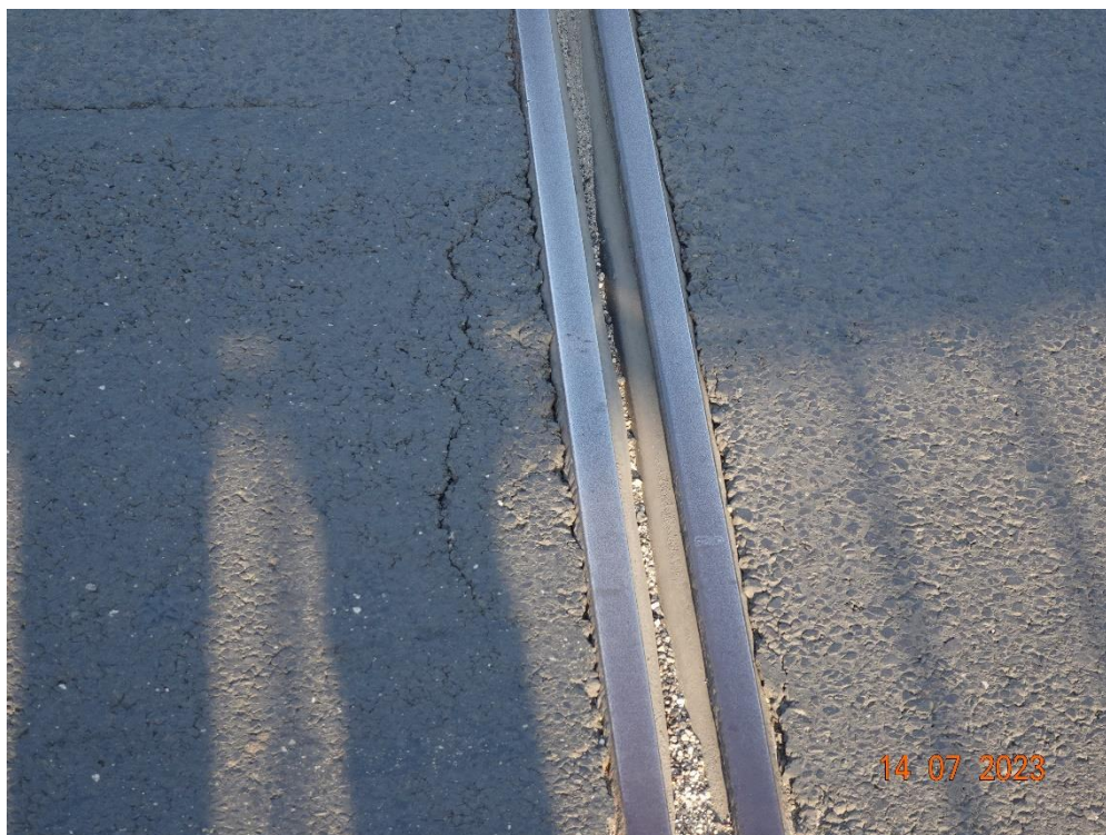
Fot. 118. Zarysowanie nawierzchni przy dylatacji. Podpora 9. Przyczyną jest oddziaływanie dynamiczne kół pojazdów oraz utrata nośności nawierzchni. Widoczne także nieuszczelnione połączenie między asfaltem a profilem dylatacyjnym.
