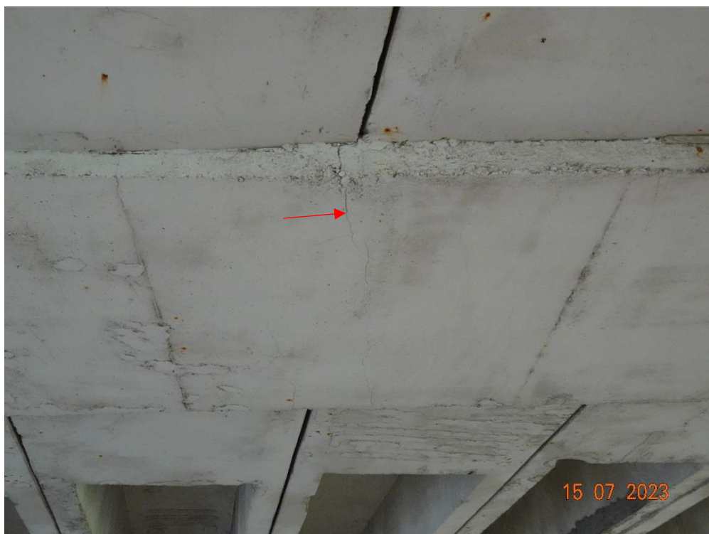
Fot. 136. Podpora 7. Zarysowania oczeput. Uszkodzenie występuje analogicznie na wszystkich podporach. Przypuszczalną przyczyną może być przeciążenie lub ewentualnie korozja zbrojenia oczeput.
