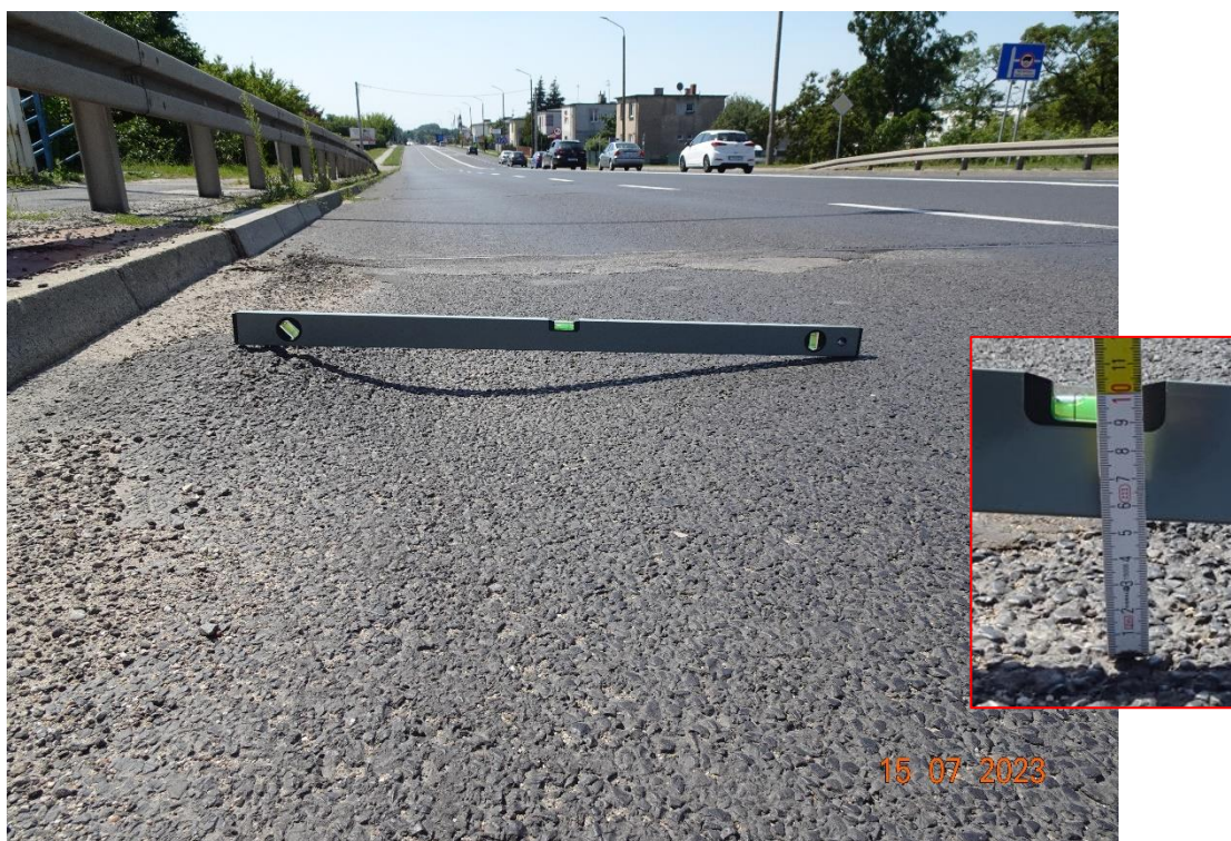
Fot. 40. Skoleinowanie nawierzchni na obiekcie na poziomie 5 cm – przyczyną jest utrata nośności oraz ruch ciężkich pojazdów.
