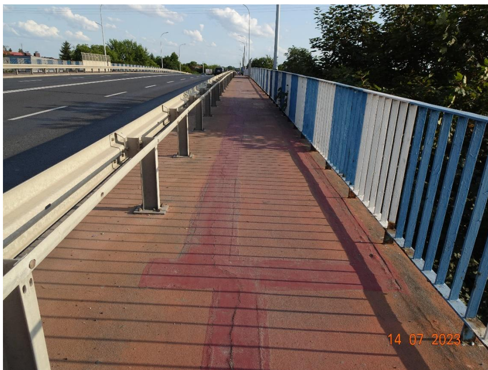
Fot. 45. Chodnik po stronie zachodniej. Widoczne ślady napraw zarysowań oraz odnowione zarysowania nawierzchni. Przyczyną jest błędne rozwiązanie projektowe połączenia elementów betonowych pod nawierzchnią. Uszkodzenie występuje na obu chodnikach, na całej długości obiektu.
