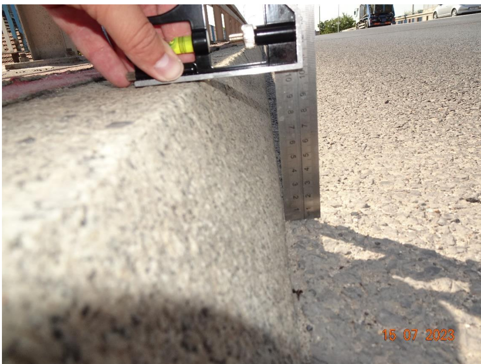
Fot. 55. Krawężnik po stronie wschodniej. Wysokość 10,5 cm – wartość dopuszczalna.
