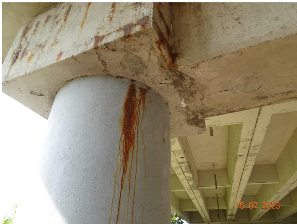
Fot. 130. Podpora nr 5. Zarysowania i korozja zbrojenia. Przyczyną jest przenikanie wody przez urządzenie dylatacyjne.
