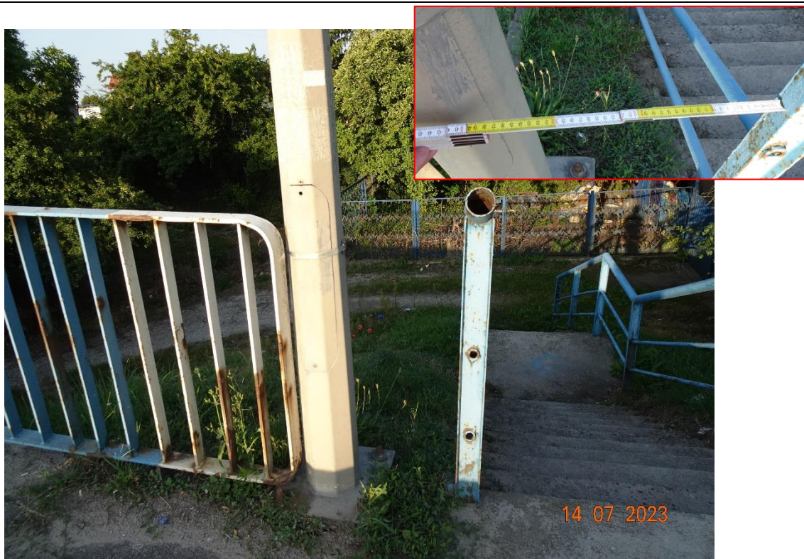
Fot. 33. Brak odpowiedniego wykończenia poręczy balustrady przy schodach; odległość między balustradą a latarnią pozwala na niekontrolowane wejście na skarpe.
