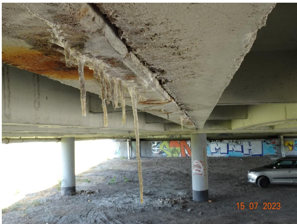
Fot. 89. Przęsło 2-3. Stalaktyty w miejscu zarysowania betonu. Świadczą o przenikaniu wody przez nieszczelną izolację pomostu. Woda przenika do zbrojenia i powoduje jego korozję.
