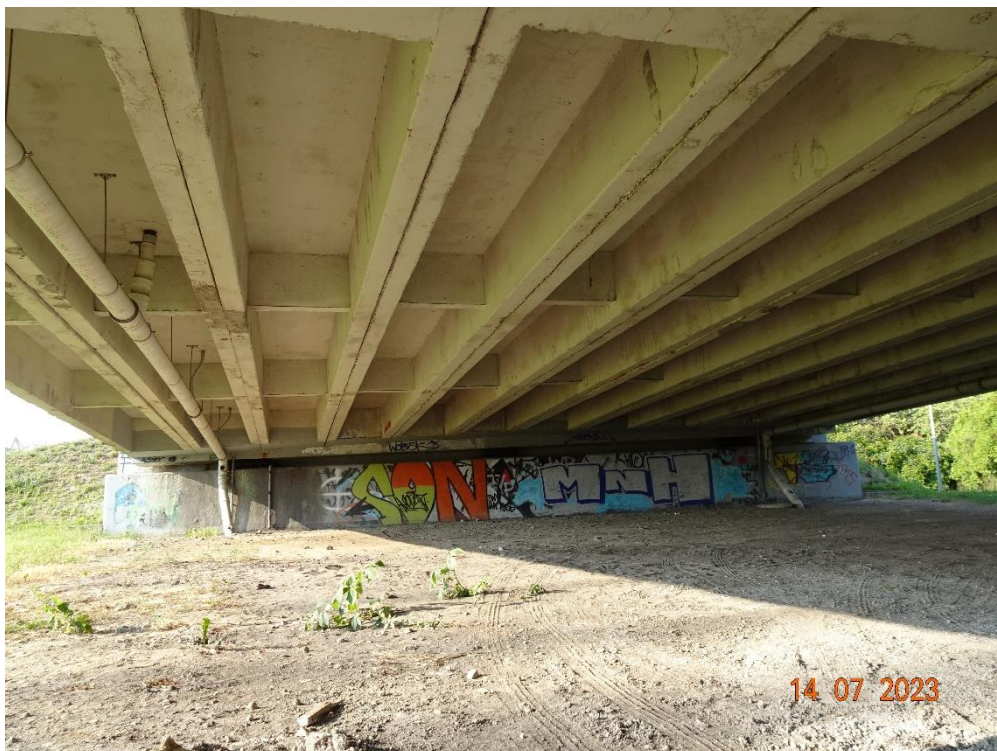
Fot. 12. Przęsło 1-2, przyczółek nr 1.
