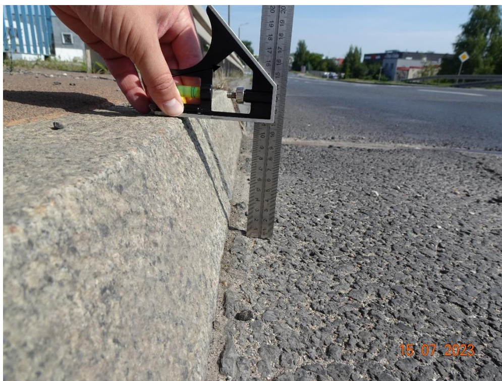
Fot. 49. Krawężnik po stronie zachodniej. Wysokość 11 cm ponad nawierzchnią – wartość dopuszczalna.
