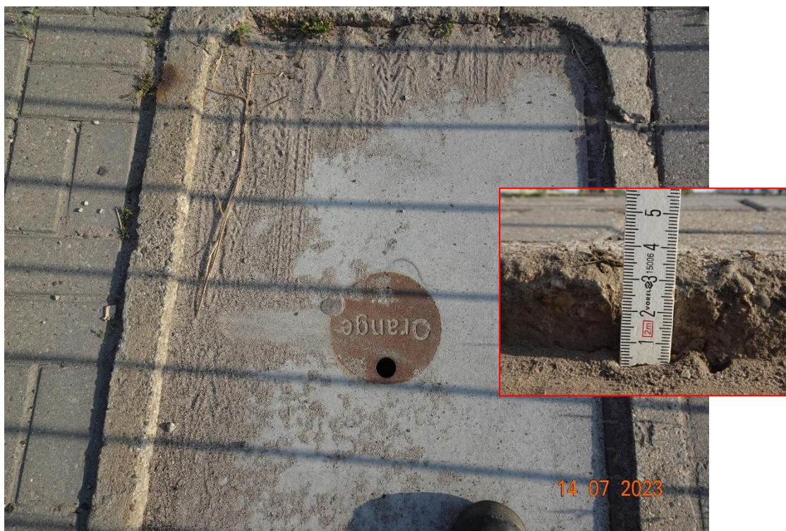
Fot. 42. Studzienka teletechniczna zlokalizowana przed obiektem od strony centrum, po stronie zachodniej. Obniżenie względem nawierzchni chodnika o 2-3 cm stwarzające ryzyko potknięcia pieszych.
