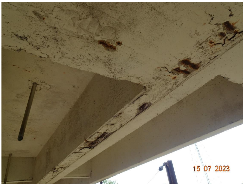
Fot. 93. Ubytki betonu spowodowane zaawansowaną korozją zbrojenia. Przęsło 4-5.
