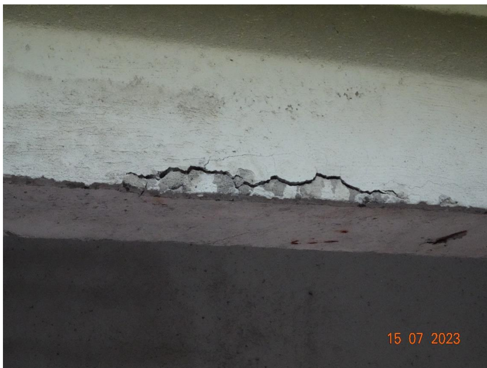
Fot. 101. Zarysowania betonu spowodowane korozją zbrojenia. Przęsło 8-9.
