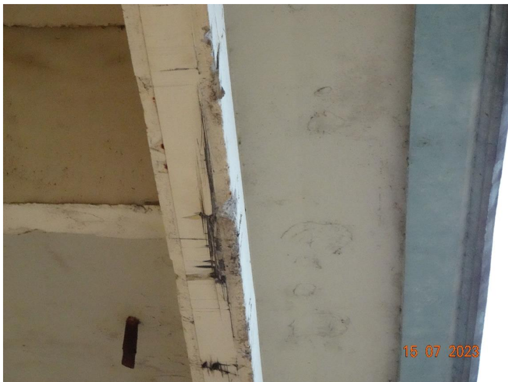
Fot. 92. Ślad po kolizji. Przęsło 3-4, dojazd od wschodu.
