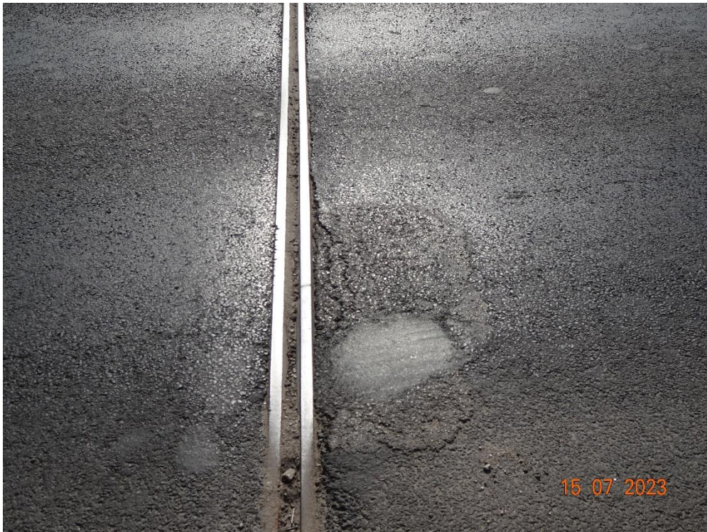
Fot. 111. Urządzenie dylatacyjne nad podporą 1. Ubytki i zarysowania nawierzchni na styku ze stalowymi profilami. Przyczyną jest brak wykonania zalewek bitumicznych oraz kształt profilu dylatacyjnego, a także dynamiczne oddziaływania kół pojazdów. Widoczne ślady naprawy nawierzchni, jednak obecnie miejsce to jest skoleinowane. Zanieczyszczenie gumowej wkładki oraz korozja stalowych profili.
