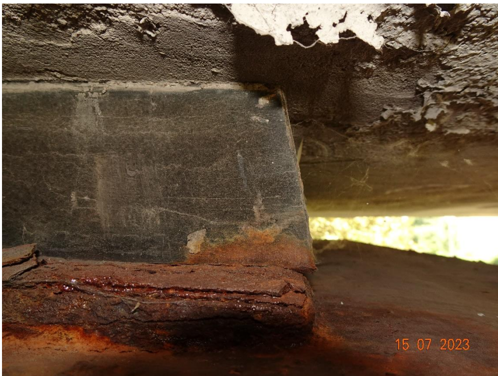
Fot. 105. Łożyska elastomerowe na podporze nr 5. Zaawansowana korozja blach dolnych (spowodowana przez brak zabezpieczenia antykorozyjnego).
