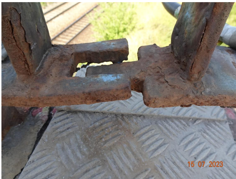
Fot. 59. Zaawansowana korozja balustrad. Przyczyną jest starzenie powłok antykorozyjnych. Deformacja elementów dylatacyjnych na balustradzie spowodowana przypuszczalnie kolizją tych elementów.
