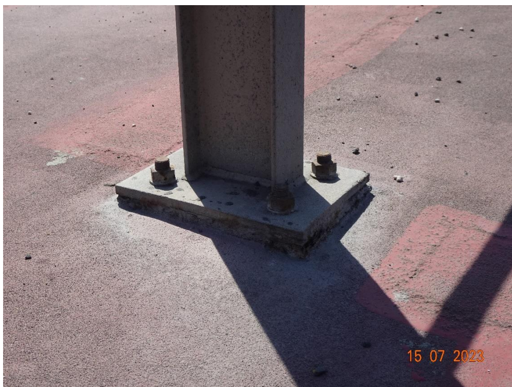
Fot. 70. Typowy widok podstawy słupka bariery. Brak zabezpieczenia antykorozyjnego łączników.
