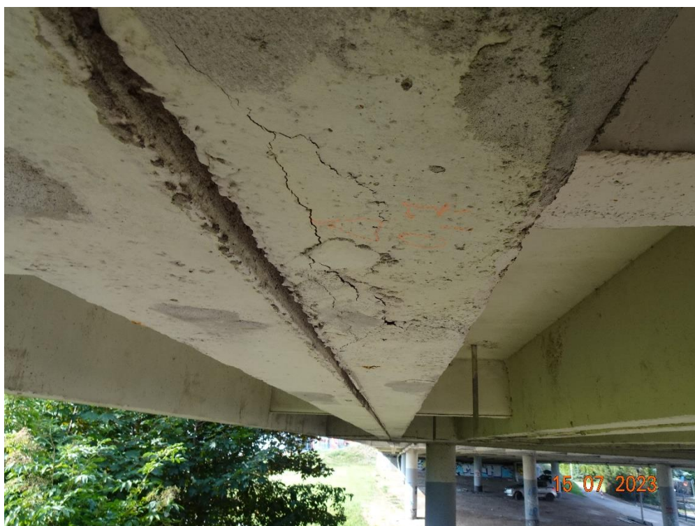
Fot. 94. Zarysowania dźwigarów wzdłuż korodującego zbrojenia. Na fotografii dźwigar od strony zachodniej, pomierzona rysa o rozwarości 0,7 mm. Przęsło 4-5.
