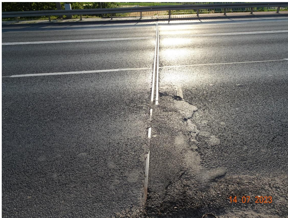
Fot. 117. Urządzenie dylatacyjne nad podporą nr 9. Stan awaryjny – ubytek stalowego profilu, doraźne wypełnienie przestrzeni masą asfaltową. Koleiny przy dylatacji.
