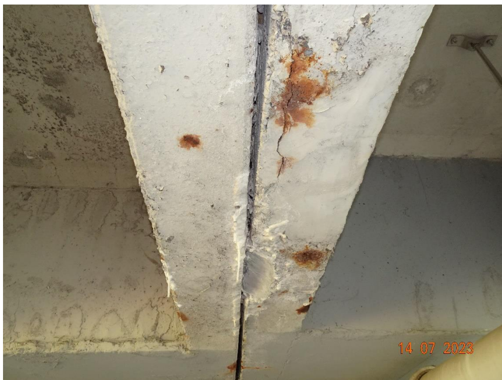
Fot. 84. Przęsło 1-2. Korozja zbrojenia belek (zbrojenie sprężające). Liczne i rozległe zarysowania wzdłuż korodującego zbrojenia. Stalaktyty świadczące o przenikaniu wody przez izolację.
