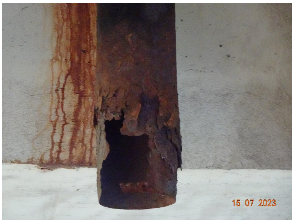
Fot. 78. Typowy widok rury wpustu – zaawansowana korozja wżerowa (zniszczenie struktury materiału) spowodowana brakiem zabezpieczenia antykorozyjnego.
