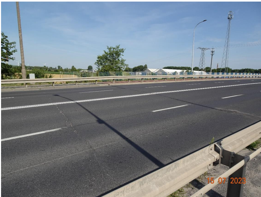
Fot. 36. Widok nawierzchni w obrębie dojazdu od południa. Poprzeczna rysa technologiczna oraz liczne poprzeczne zarysowania świadczące o utracie nośności warstw nawierzchni.
