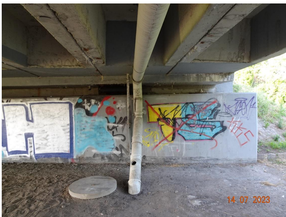
Fot. 76. Kolektor odwodnienia przy podporze nr 1 – brak nakrętki. Ponadto widoczne graffiti na podporze nr 1 oraz stalaktyty na dźwigarach świadczące o przeciekach przez izolację.
