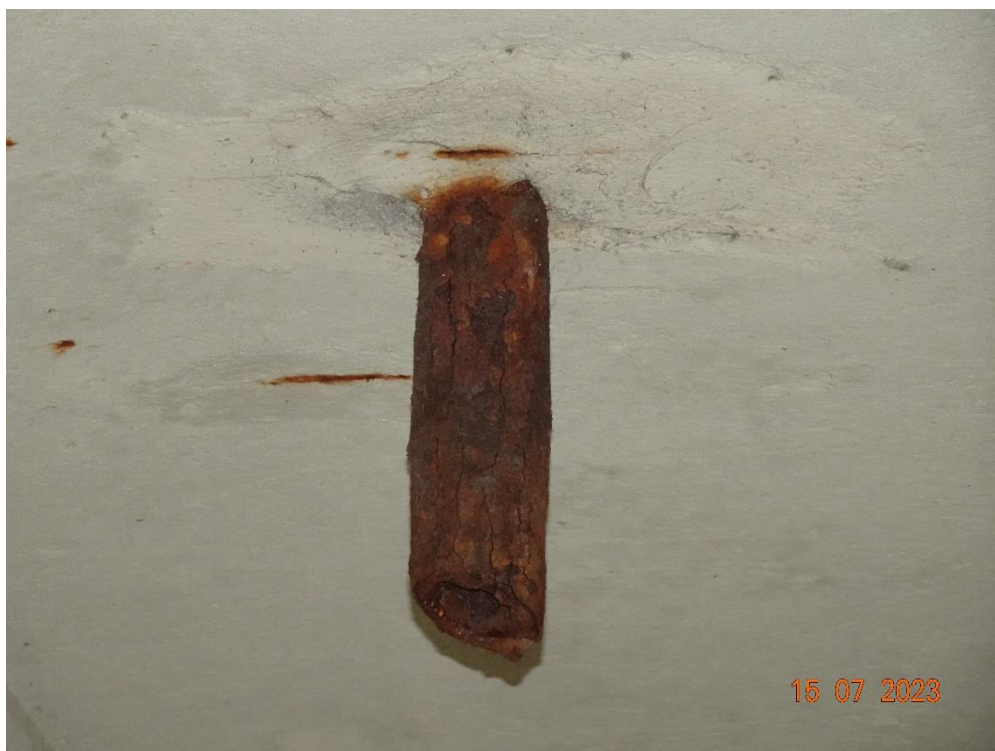
Fot. 77. Typowy widok sącza – zaawansowana korozja wżerowa spowodowana brakiem zabezpieczenia antykorozyjnego.
