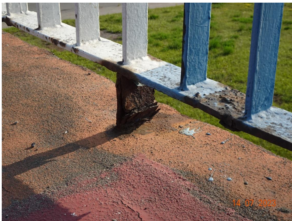
Fot. 58. Zaawansowana korozja balustrad. Przyczyną jest starzenie powłok antykorozyjnych. Uszkodzenie występuje w różnym stopniu na całym obiekcie.
