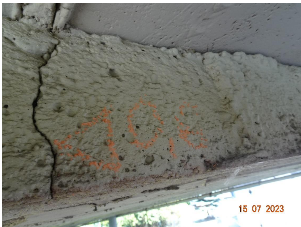
Fot. 124. Podpora nr 3. Zarysowanie oczepu podpierającego belki korytkowe. Uszkodzenie występuje analogicznie na wszystkich podporach. Przypuszczalną przyczyną może być przeciążenie lub ewentualnie korozja zbrojenia oczepu.
