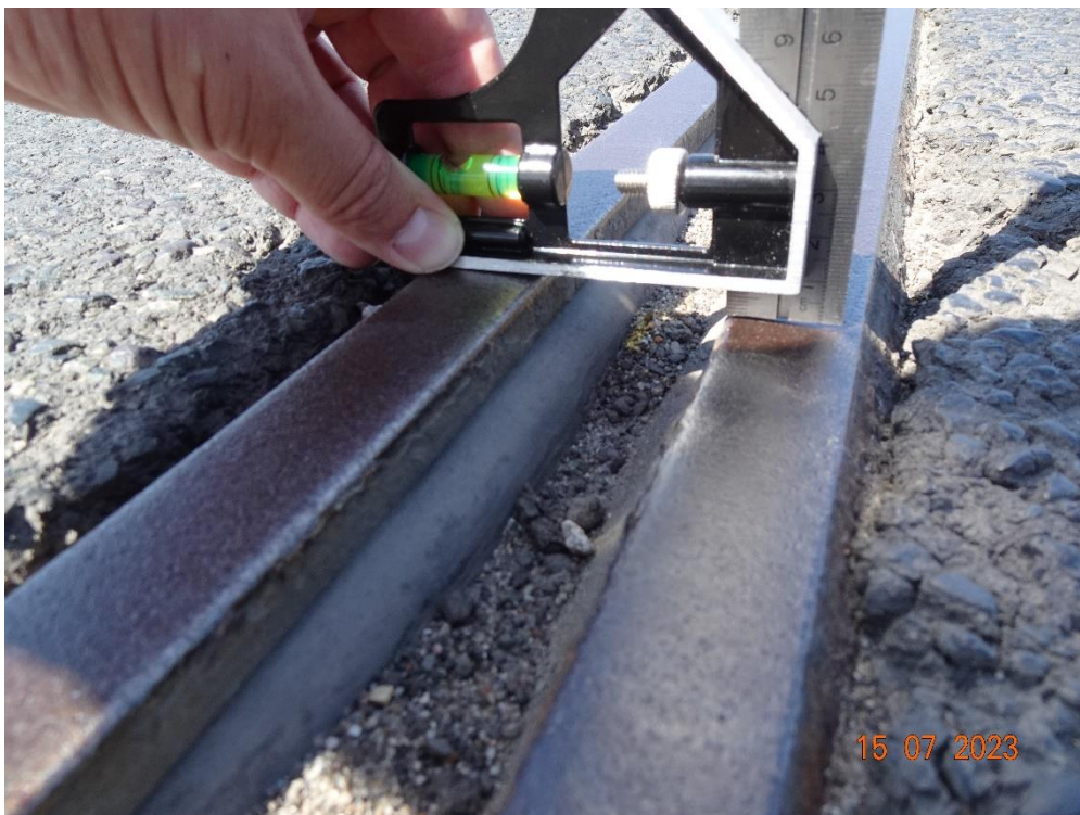
Fot. 112. Różnica wysokości między profilami dylatacyjnymi około 1 cm. Podpora 1. Stan ten wzmacnia efekty dynamiczne od przejeżdżających pojazdów.
