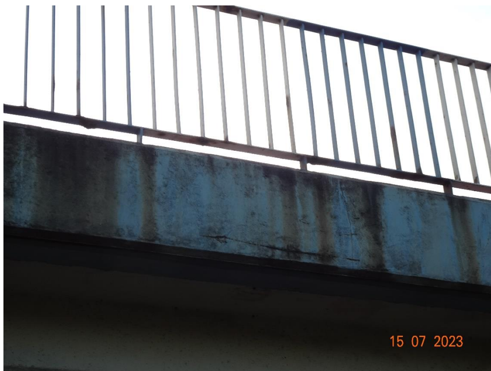
Fot. 75. Zanieczyszczenia gzymsu.
