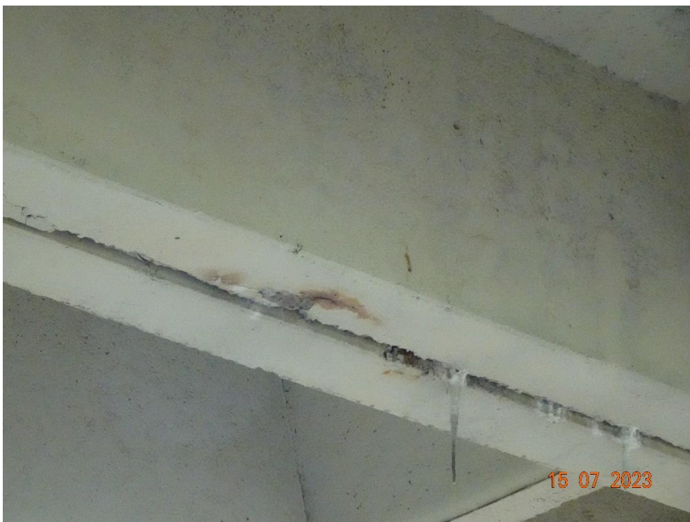
Fot. 98. Przęsło 5-6. Stalaktydy na połączeniach sąsiednich belek. Przyczyną jest przeciekanie wody przez niesprawną izolację. Uszkodzenie typowe dla całego obiektu. Ponadto uszkodzenie izolacji na styku belek typowo występuje w innych obiektach gdzie konstrukcję nośną stanowią belki korytkowe – przyczyną podawaną w literaturze jest klawiszowanie sąsiednich belek.
