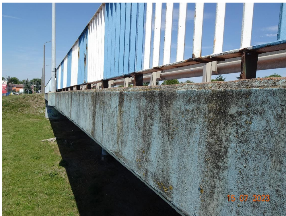
Fot. 71. Gzyms po stronie zachodniej. Zanieczyszczenia.
