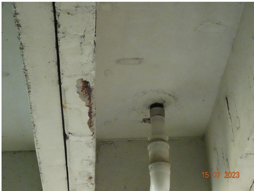
Fot. 91. Ubytek betonu spowodowany zaawansowaną korozją zbrojenia. Przęsło 3-4.
