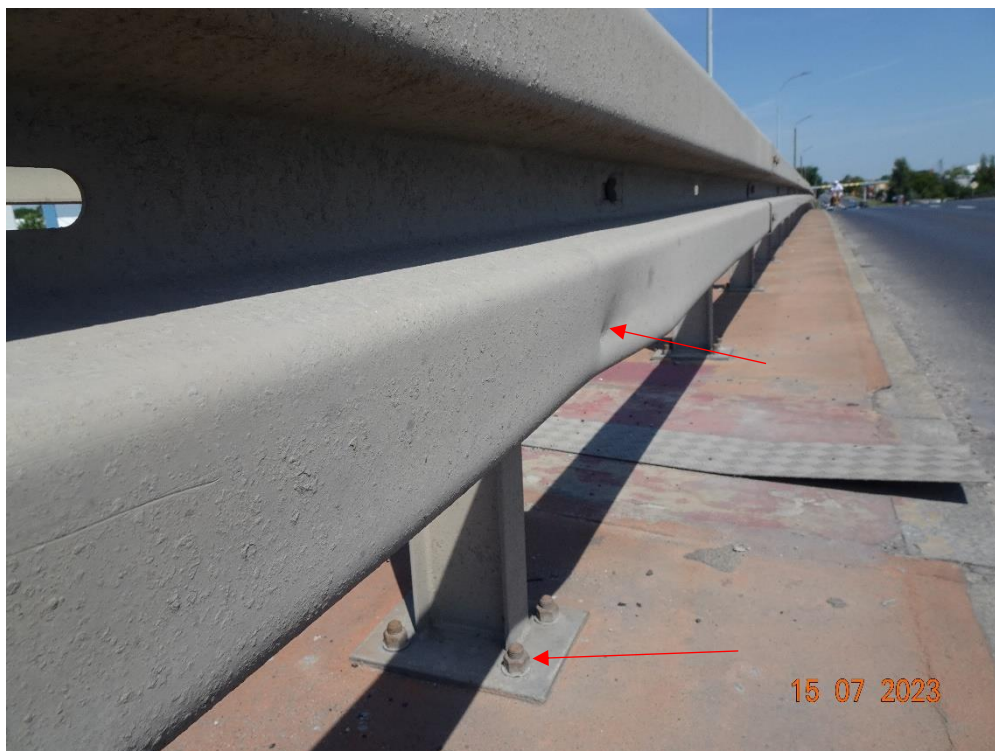
Fot. 63. Deformacja bariery po stronie zachodniej spowodowana kolizją; początki korozji łączników mocujących bariery; deformacja osłony urządzenia dylatacyjnego nad podporą nr 5 spowodowana czynnikiem mechanicznym.
