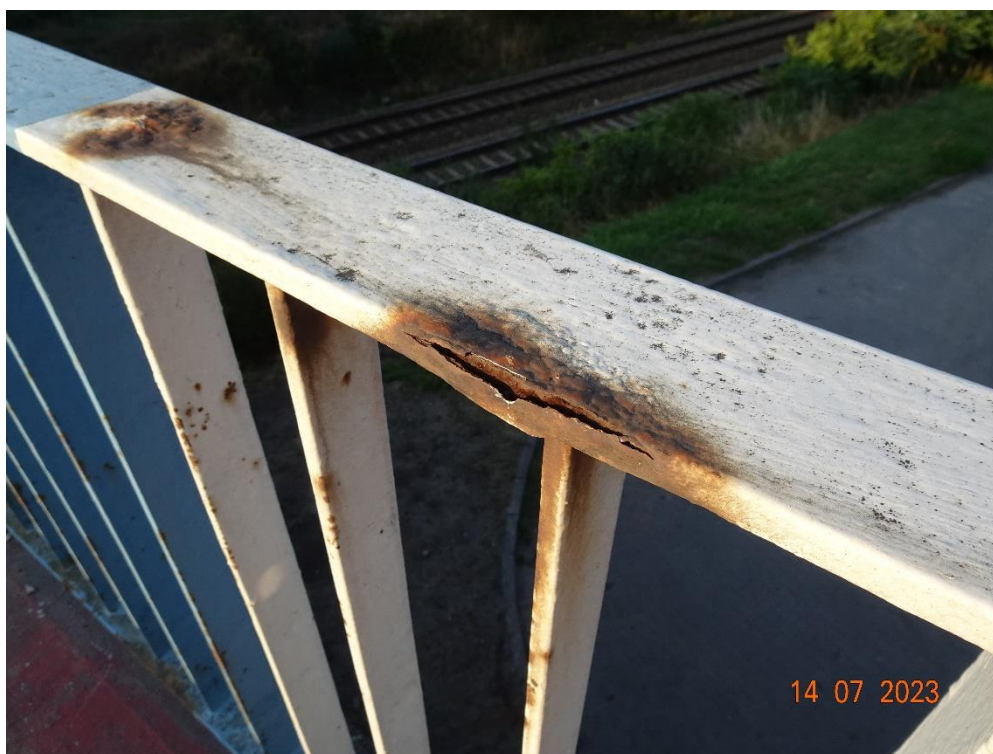
Fot. 64. Ubytek powłoki antykorozyjnej oraz korozja balustrady (strona wschodnia).
