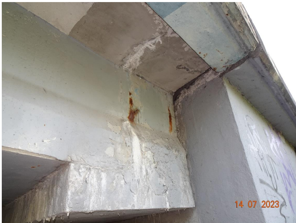
Fot. 83. Poprzecznicą podporowa nad podporą nr 1. Korozja zbrojenia, osady świadczące o przeciekaniu wody.
