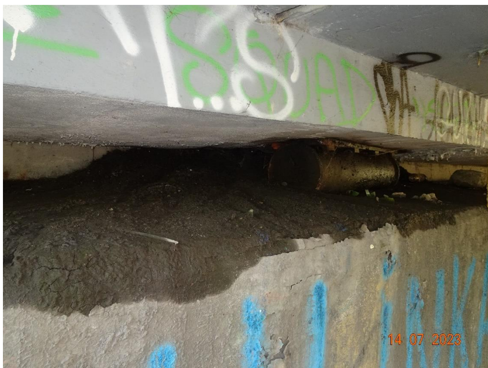
Fot. 122. Przyczółek nr 9. Akumulacja zanieczyszczeń spowodowana awarią urządzenia dylatacyjnego. Widoczne też zawilgocenie świadczące o przeciekach wody przez urządzenie dylatacyjne.
