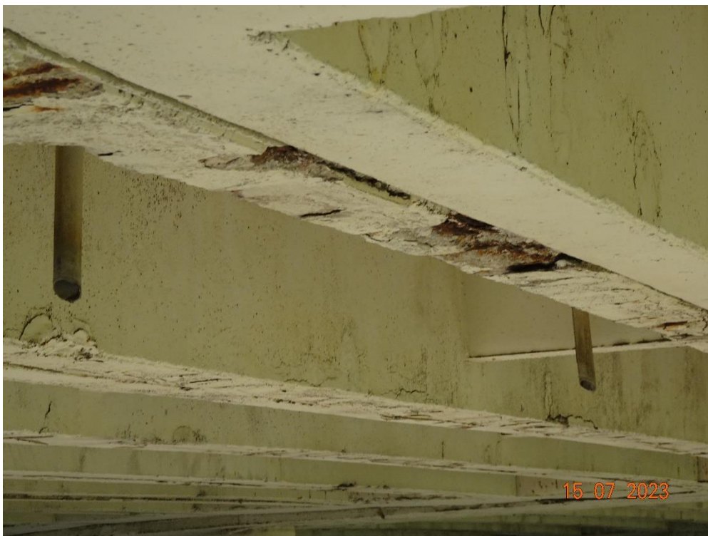
Fot. 97. Ubytki betonu i zaawansowana korozja zbrojenia w dźwigarze, w obrębie przęśła 5-6. Beton odpadający w tym przęśle stanowi ryzyko dla przejeżdżających pociągów.
