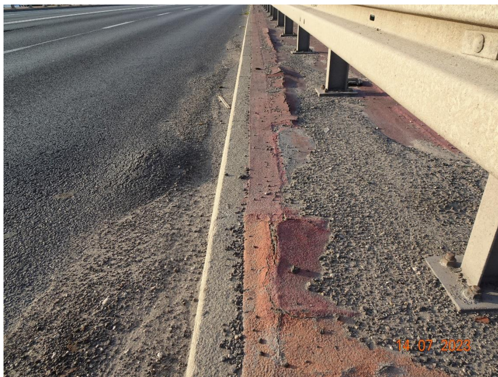
Fot. 51. Chodnik po stronie wschodniej. Akumulacja zanieczyszczeń na chodniku oraz na jezdni. Pęknięcia nawierzchni chodnika.
