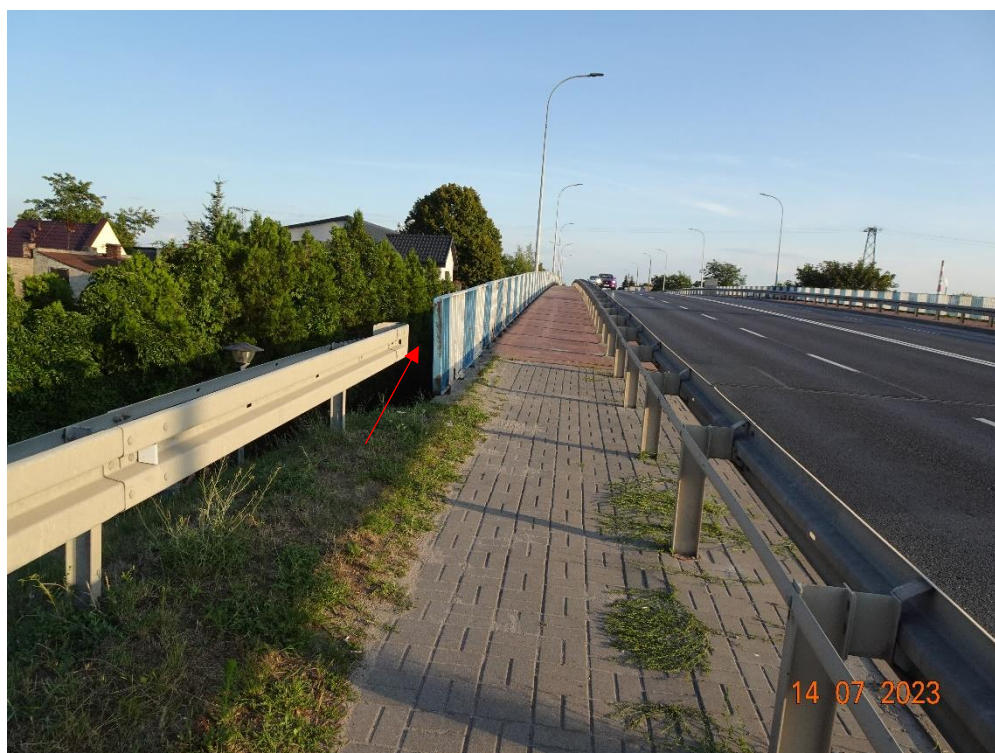
Fot. 54. Chodnik po stronie wschodniej. Wegetacja roślin w obrębie dołka. Brak szczelnego zabezpieczenia przed niekontrolowanym wejściem na skarpę.
