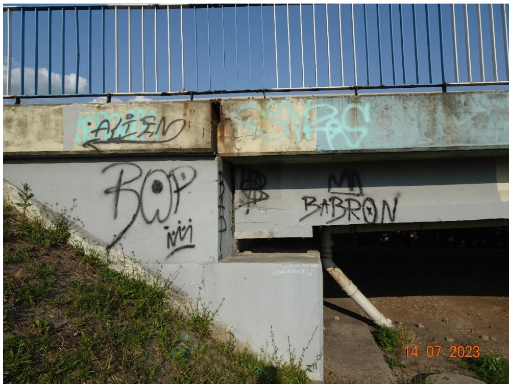
Fot. 119. Przyczółek 1. Widoczna korozja profilu dylatacyjnego; graffiti na przyczółku i na dźwigarze; zarysowania gipsu w pobliżu dylatacji.
