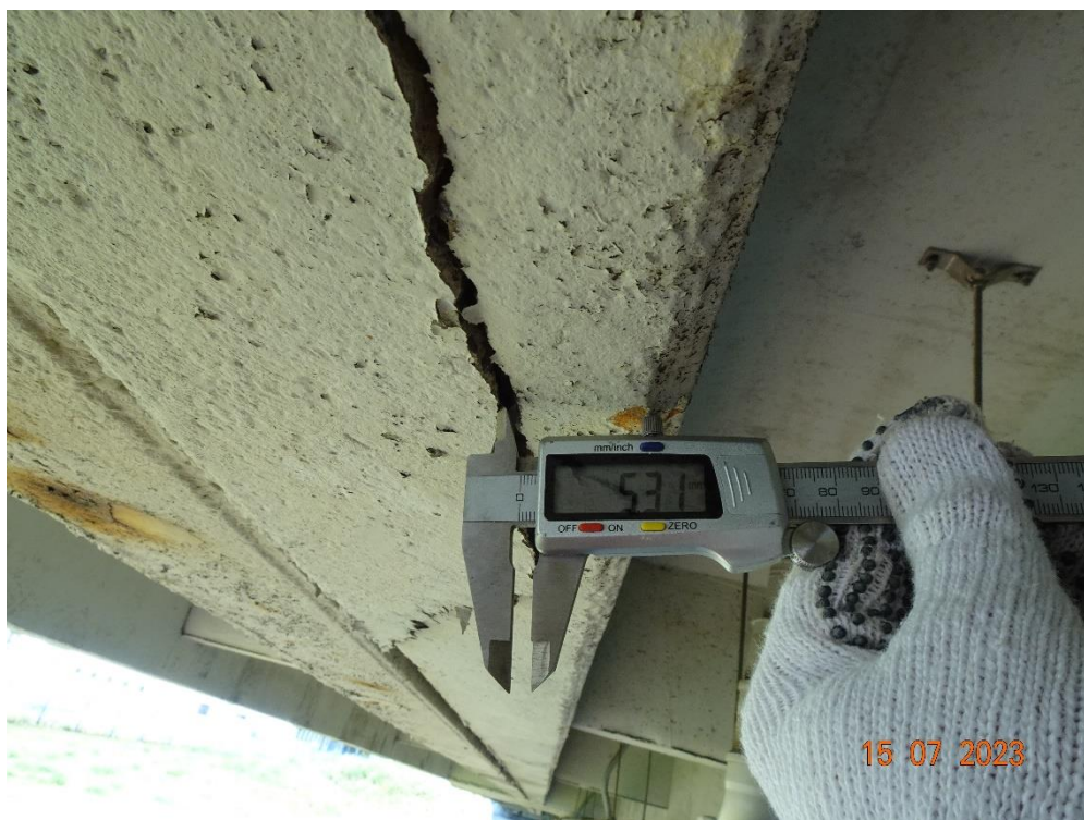
Fot. 90. Przęsło 2-3. Zarysowania wzdłuż korodującego zbrojenia o rozwarości 5,3 mm; odspojenie betonu.
