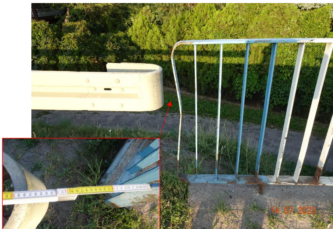
Fot. 68. Deformacja balustrady oraz korozja. Widok po stronie wschodniej, przy podporze nr 1. Przestrzeń między barierą drogową a balustradą pozwala na niekontrolowane wejście na skarpe.
