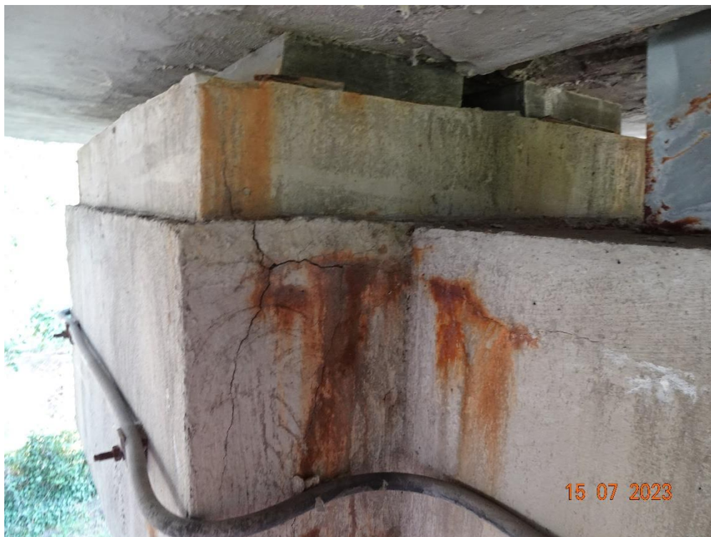
Fot. 131. Podpora nr 5. Zarysowania betonu oczeput, rdzawe zacieki pochodzące od korozji zbrojenia oraz przeciekania wody przez rysy. Charakter uszkodzeń wskazuje na przeciekanie wody ze szczeliny dylatacyjnej.
