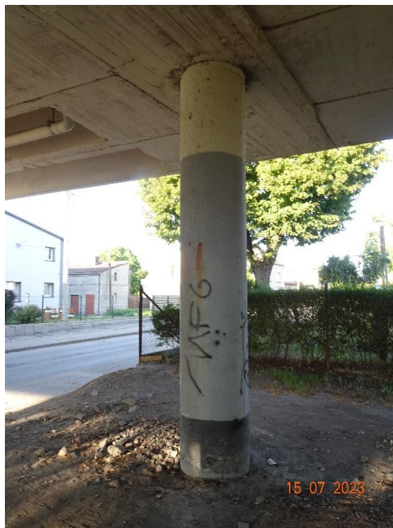
Fot. 127. Podpora 4. Graffiti oraz rdzawy zacieki.
