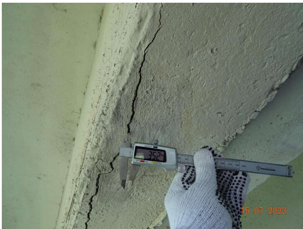
Fot. 87. Przęsło 2-3. Zarysowania wzdłuż korodującego zbrojenia o rozwartości 3,5 mm.
