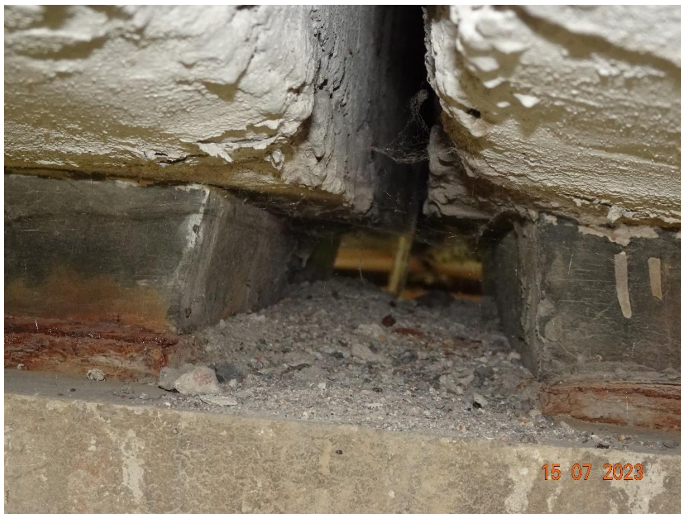
Fot. 104. Łożyska elastomerowe na podporze nr 5. Zaawansowana korozja blach dolnych (spowodowana przez brak zabezpieczenia antykorozyjnego), akumulacja zanieczyszczeń. Brak wskaźników przesuwu, ale stwierdza się, że zaobserwowane przesuwu łożysk są adekwatne do temperatury konstrukcji (około 1 cm w kierunku szczeliny dylatacyjnej z obu stron).
