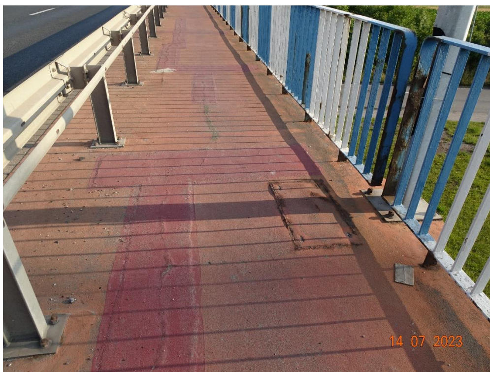
Fot. 44. Chodnik po stronie zachodniej. Widoczne ślady napraw zarysowań oraz odnowione zarysowania nawierzchni. Przyczyną jest błędne rozwiązanie projektowe połączenia elementów betonowych pod nawierzchnią.
