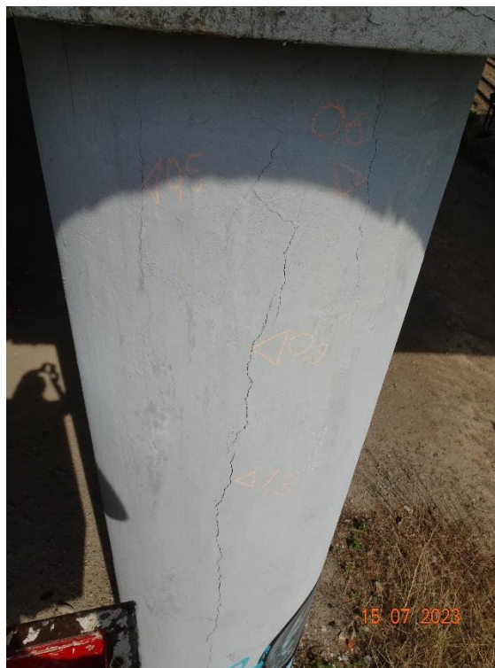
Fot. 132. Podpora nr 5. Zarysowania słupa po stronie zachodniej. Przyczyną jest korozja zbrojenia (zarysowania wzdłuż prętów).
