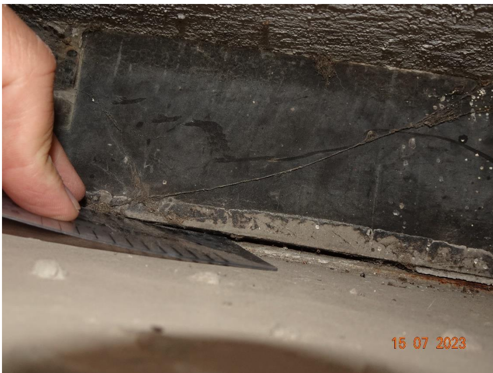
Fot. 108. Łożysko na podporze nr 5. Brak jednorodnego docisku (niewielka szczelina pod łożyskiem). Przyczyną mogą być niedokładności wykonawcze, ubytek betonu i wykruszenie cienkiej warstwy podlewki lub niedostateczny docisk (np. z powodu występowania siły odrywającej).
