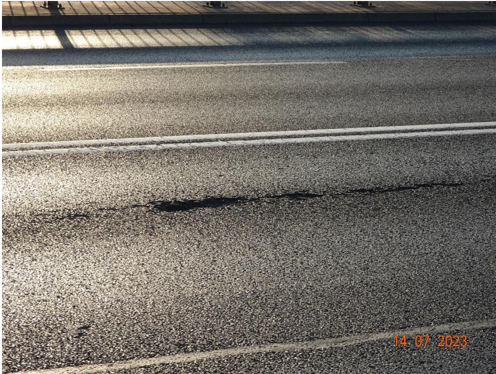
Fot. 37. Rozległy ubytek nawierzchni jezdni.
