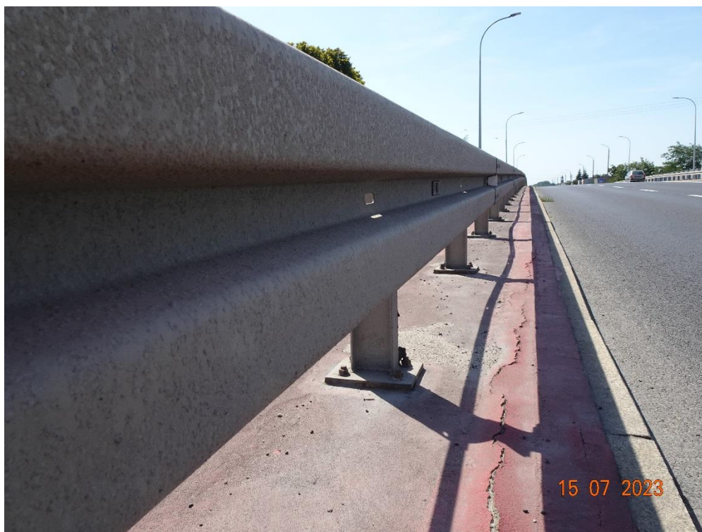
Fot. 69. Bariera po stronie wschodniej. Widok pęknięcia nawierzchni chodnika.
