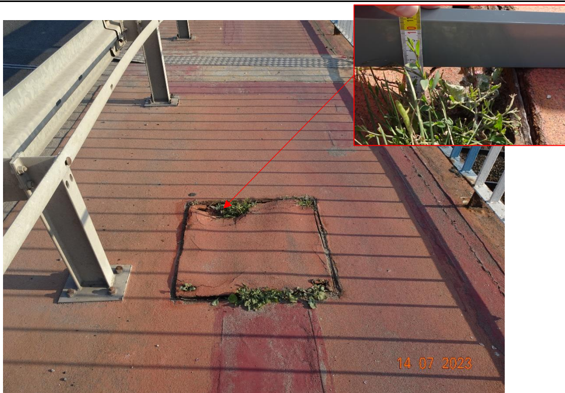
Fot. 46. Chodnik po stronie zachodniej. Deformacja pokrywy studzienki kablowej. Zagłębienia o około 8 cm powoduje zagrożenie dla ruchu pieszych; wegetacja roślin.
