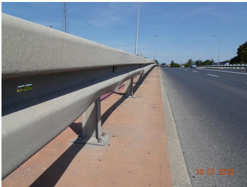
Fot. 62. Deformacja bariery po stronie zachodniej spowodowana kolizją; początki korozji łączników mocujących bariery.
