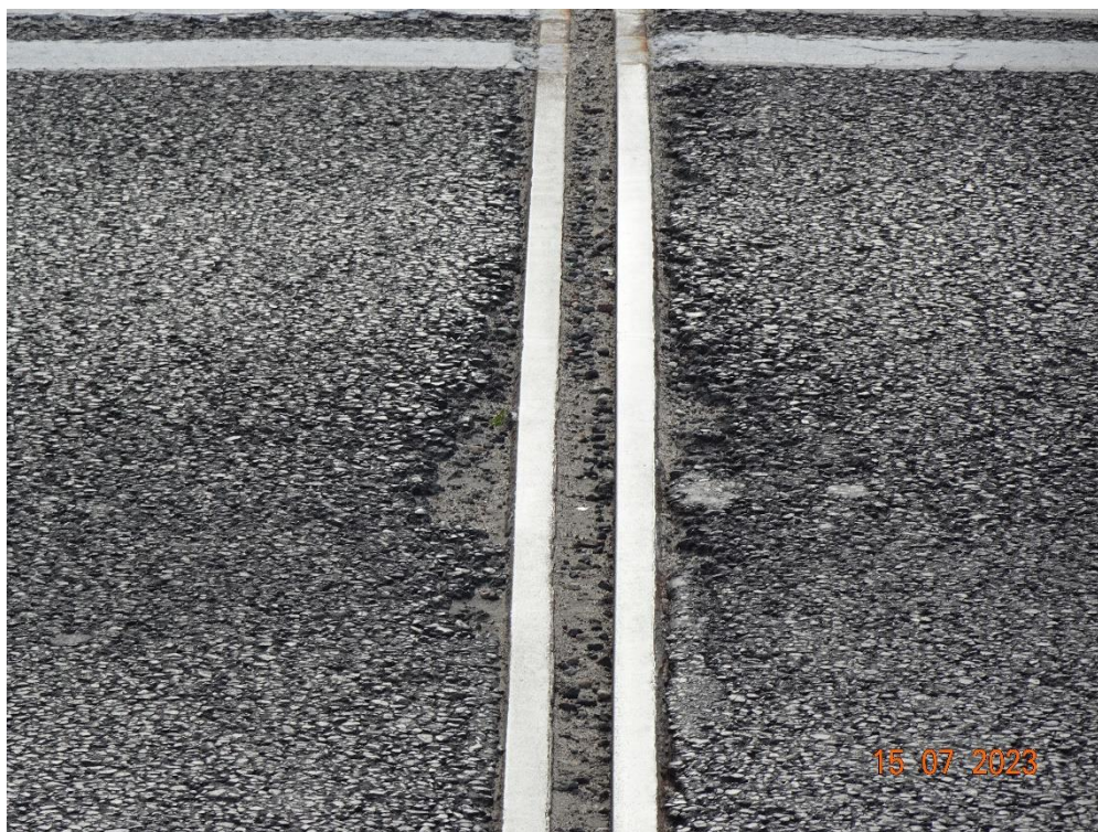
Fot. 110. Urządzenie dylatacyjne nad podporą 1. Ubytki nawierzchni na styku ze stalowymi profilami. Przyczyną jest brak wykonania elastycznych zalewek oraz kształt profilu dylatacyjnego, a także dynamiczne oddziaływania kół pojazdów.
