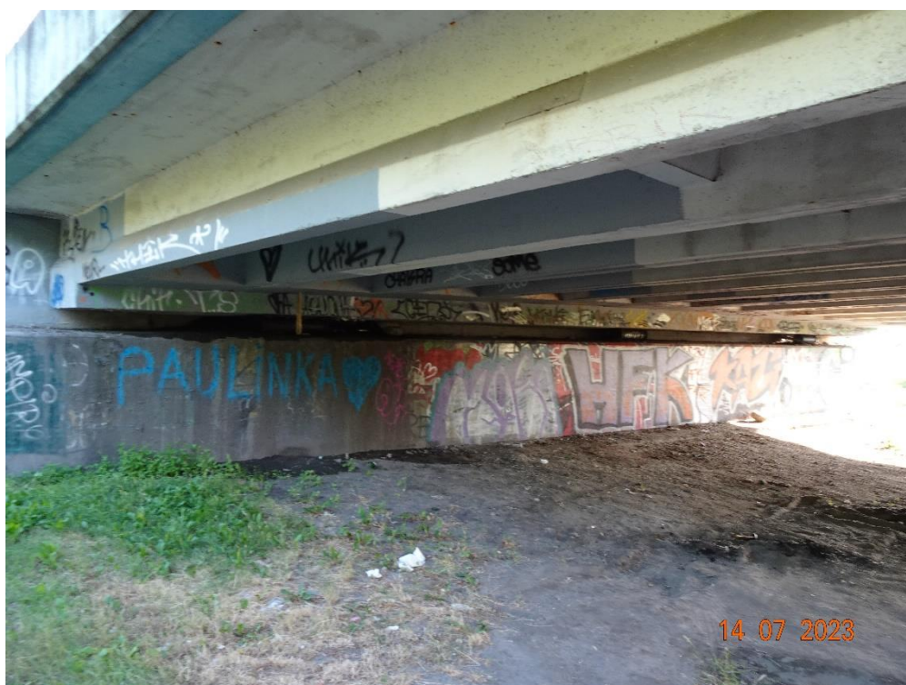
Fot. 120. Przyczółek nr 9. Zanieczyszczenia i graffiti.
