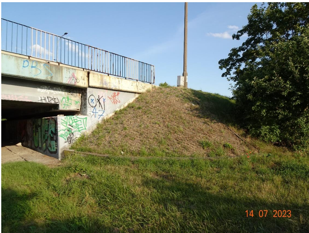
Fot. 31. Wegetacja roślin na stożkach, graffiti na przyczółkach. Widok przyczółka nr 9.
