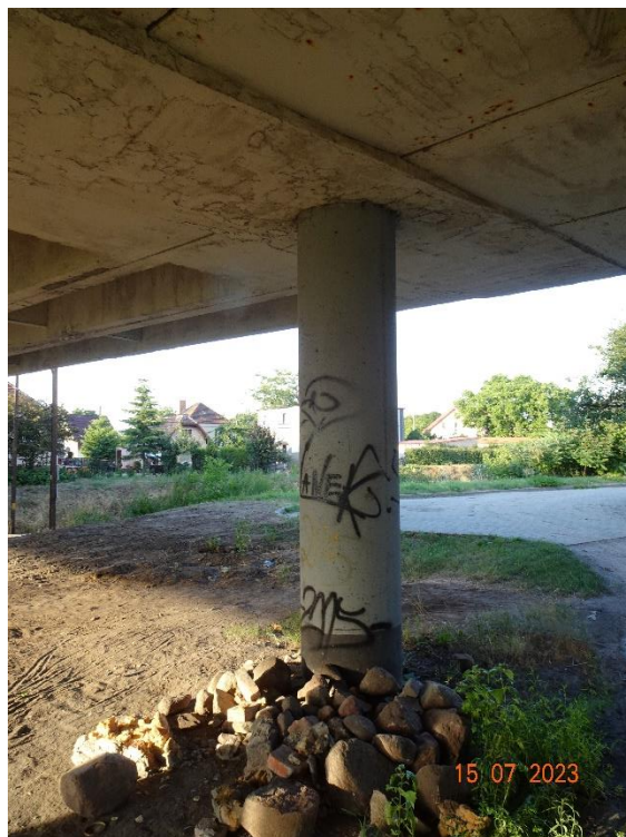
Fot. 135. Podpora nr 7. Graffiti oraz zanieczyszczenia wokół podpory.
