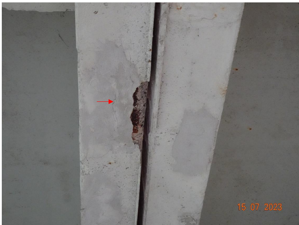
Fot. 100. Ubytek betonu i korozja zbrojenia. Widoczne także rysy na warstwach naprawczych świadczące o postępie korozji. Przęsło 6-7.
