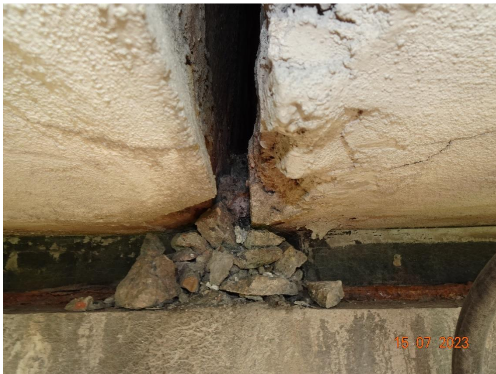
Fot. 133. Podpora nr 5. Znaczna akumulacja zanieczyszczeń na połączeniu dźwigarów. Przyczyną może być pozostawienie tych elementów na etapie remontu lub wykruszanie podczas eksploatacji.
