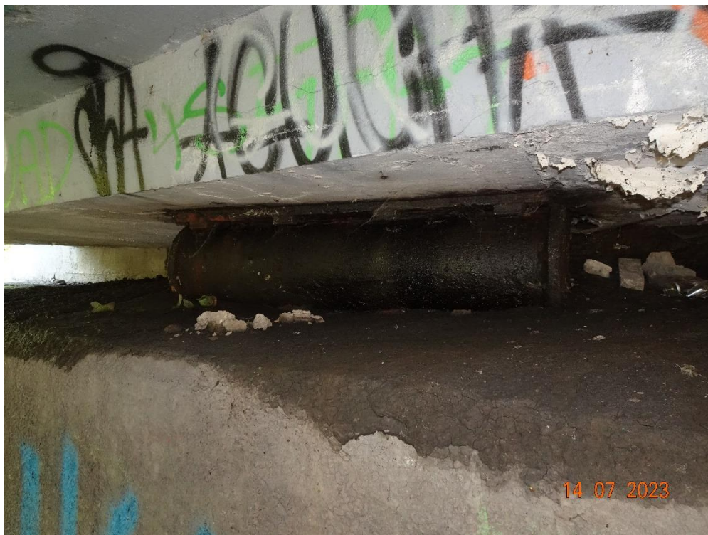
Fot. 103. Widok łożyska na podporze nr 9. Akumulacja zanieczyszczeń wokół łożyska spowodowana awarią urządzenia dylatacyjnego. Zanieczyszczenia powodują brak swobody przemieszczenia łożyska (brak możliwości toczenia).
