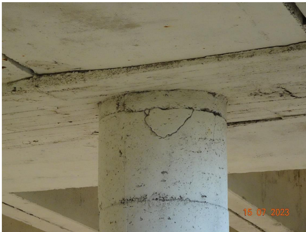
Fot. 134. Podpora nr 6. Odspojenie warstwy wyrównawczej betonu.
