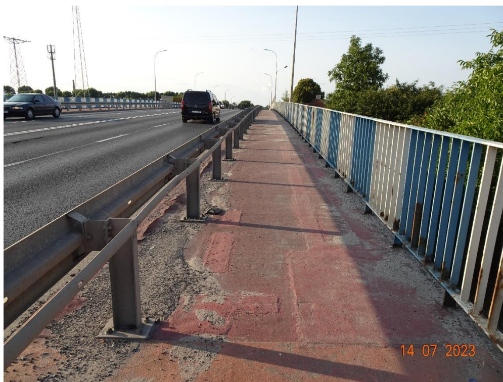
Fot. 50. Chodnik po stronie wschodniej. Akumulacja zanieczyszczeń.
