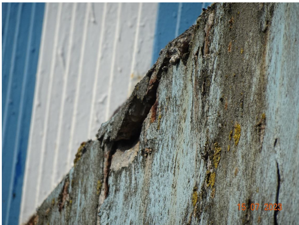
Fot. 72. Gzyms po stronie zachodniej. Ubytek betonu i korozja zbrojenia.
