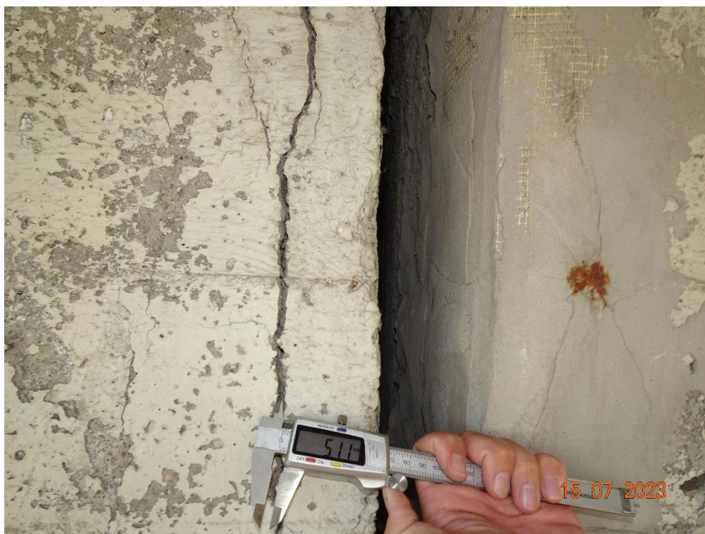
Fot. 96. Zarysowanie betonu o szerokości 5,1 mm na skraju przęśła 5-6 (nad podporą nr 5). Przepuszczalną przyczyną jest korozja zbrojenia.
