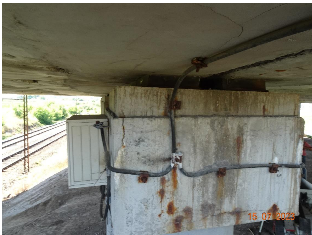
Fot. 128. Podpora nr 5. Zarysowanie z wylugowaniem; zarysowania betonowej wyprawy dźwigarów; korozja łączników mocujących kable. Ogólny charakter uszkodzeń wskazuje na przenikanie wody przez urządzenie dylatacyjne.
