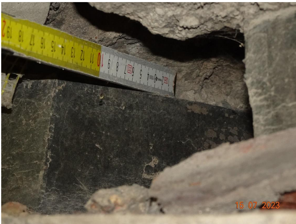
Fot. 107. Ubytek betonu nad łożyskiem elastomerowym na podporze nr 5. Przyczyną mogą być niedoskonałości wykonawcze.
